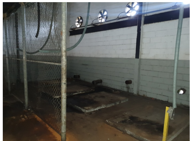
Foto 18 - Câmara de máquinas VAZIA (22/03/2022)
