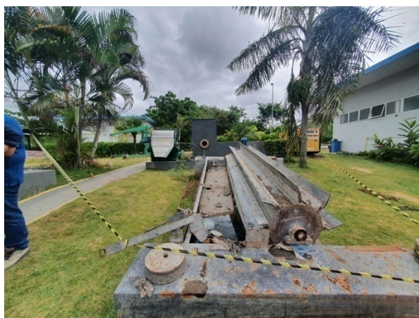
Foto 18 - Roda de drenagem desmontada
