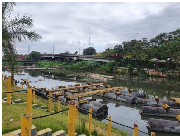
Foto 8 - Módulos flutuantes desmontados
