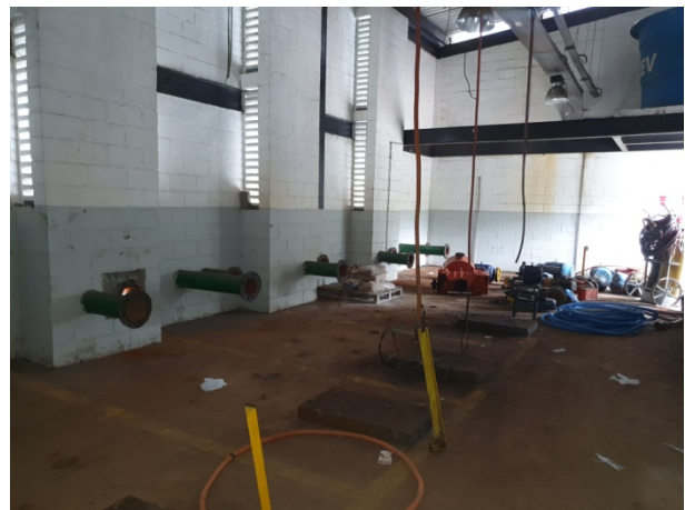
Foto 16 - Câmara de máquinas VAZIA (22/03/2022)
