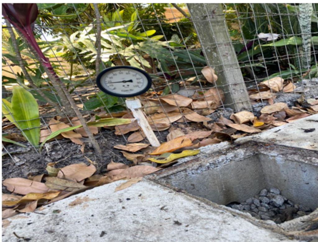
Foto 06 – Rua dos Cajueiros, 26 (Manômetro mediu 17 mca.)
