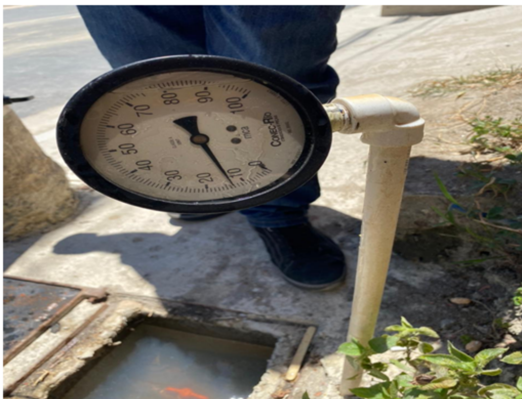
Foto 08 – Rua dos Cajueiros, 269 (Manômetro mediu 13 mca.)
