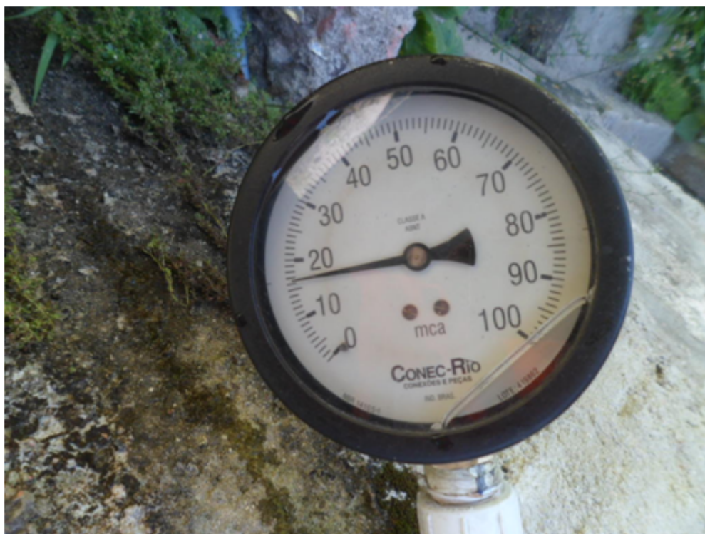
Foto 04 – Rua dos Cajueiros, 2A (Manômetro mediu 17 mca.)
