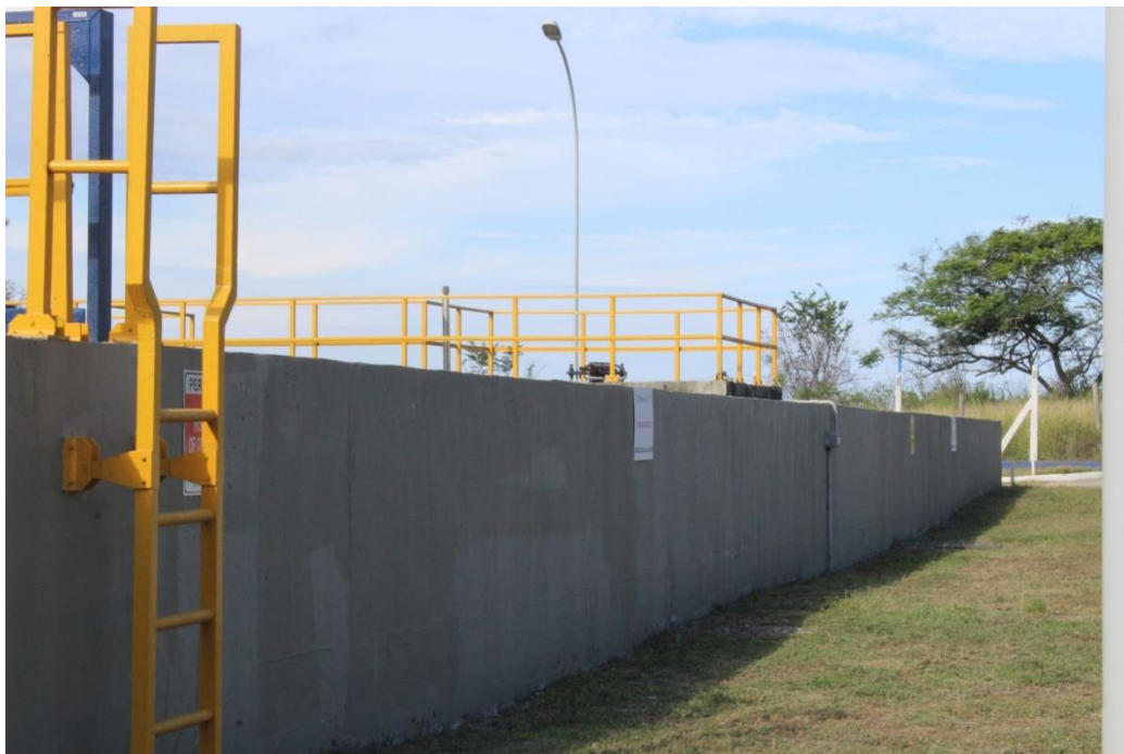
Foto 15 – Lateral dos Tanques de Aeração e Anóxico
