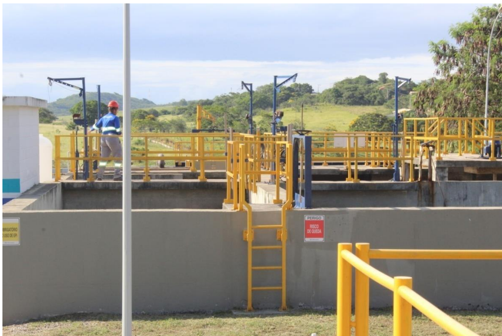
Foto 19 – Lateral dos Tanques de Aeração
