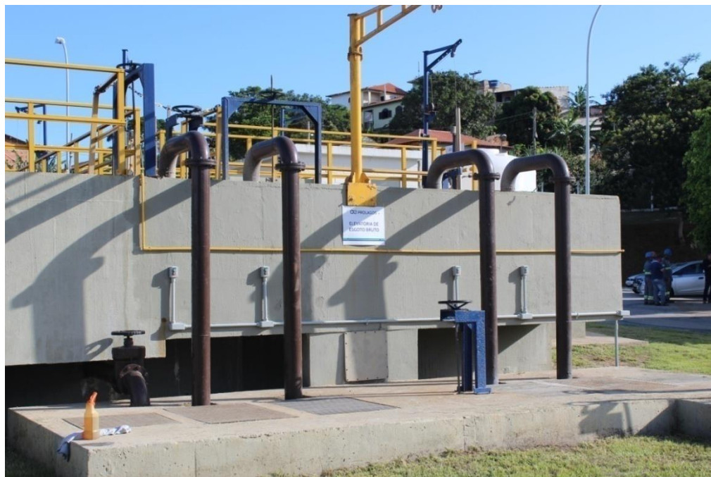
Foto 25 – Elevatória de Esgoto Bruto
