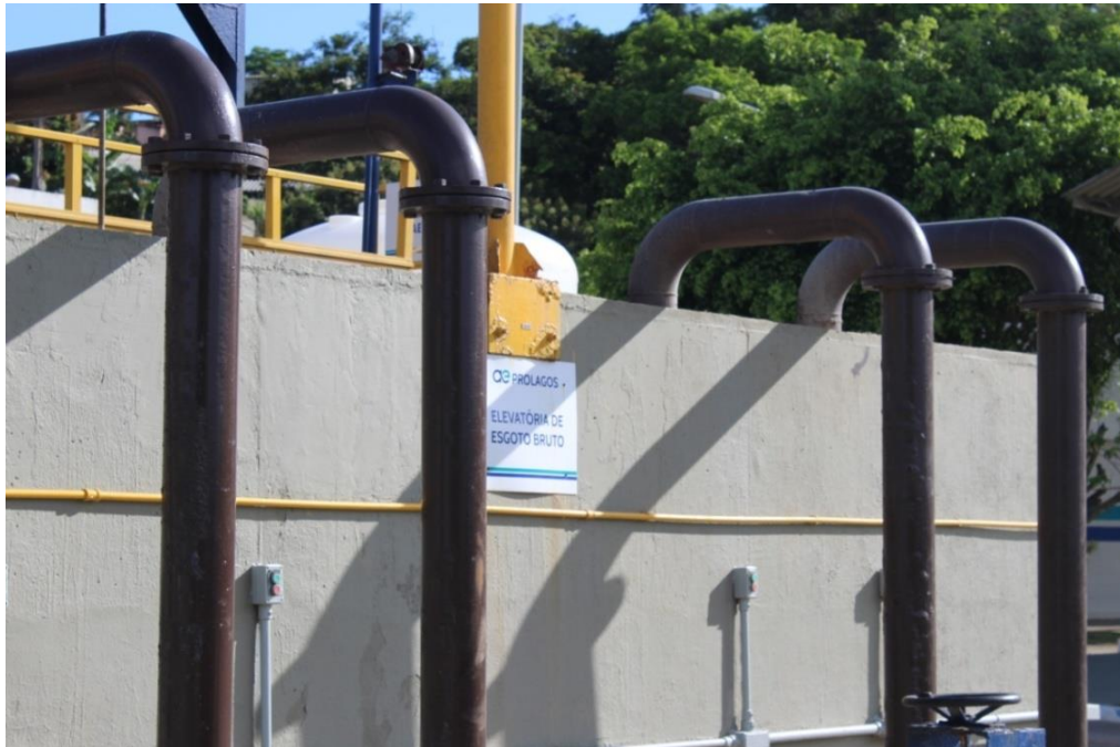
Foto 26 – Elevatória de Esgoto Bruto
