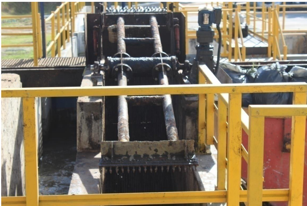
Foto 07 – Gradeamento para retenção de resíduos sólidos com pás mecânicas
