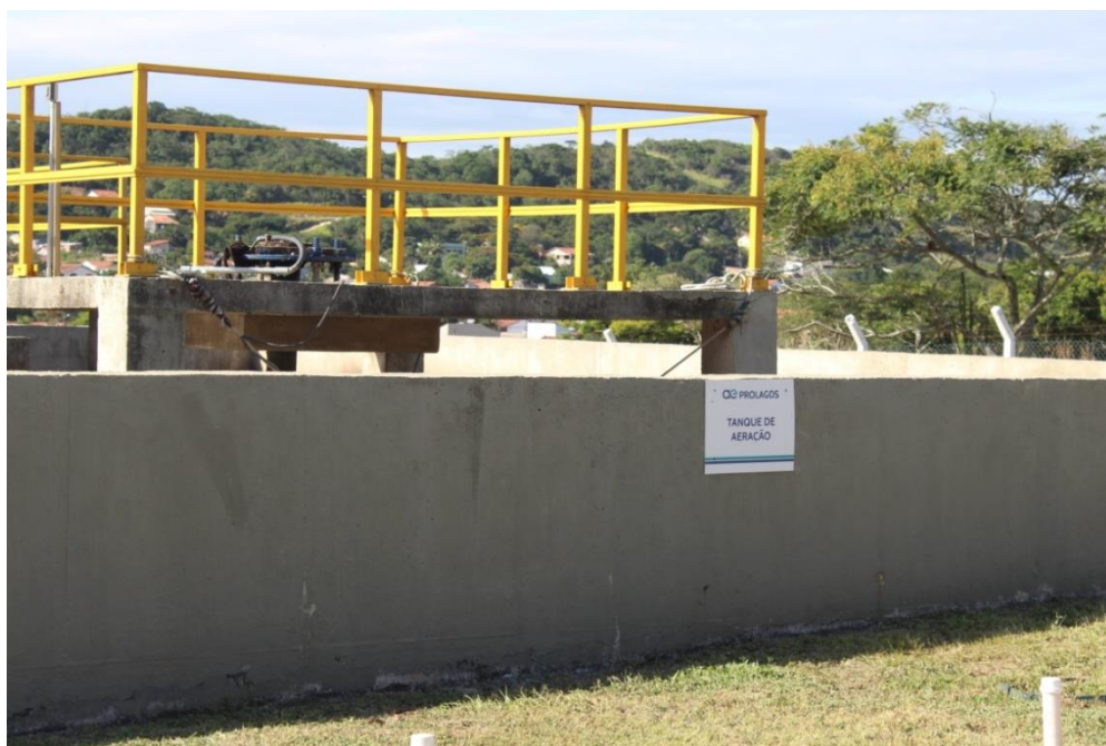
Foto 20 – Lateral dos Tanques de Aeração
