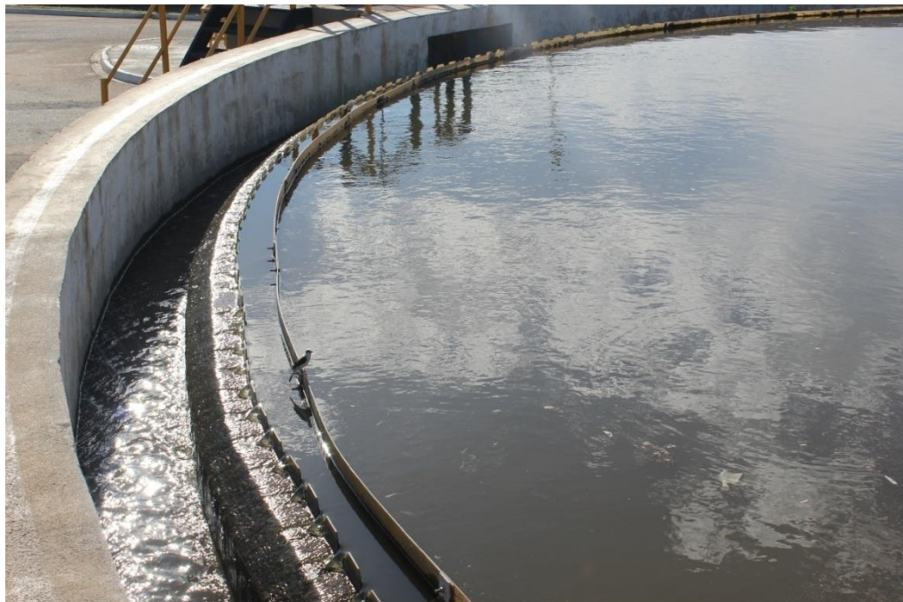
Foto 29 – Decantador (vista superior)
