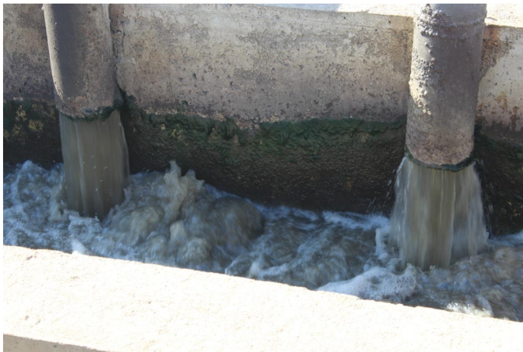
Foto 23 – Elevatória de Esgoto Bruto (vista superior)
