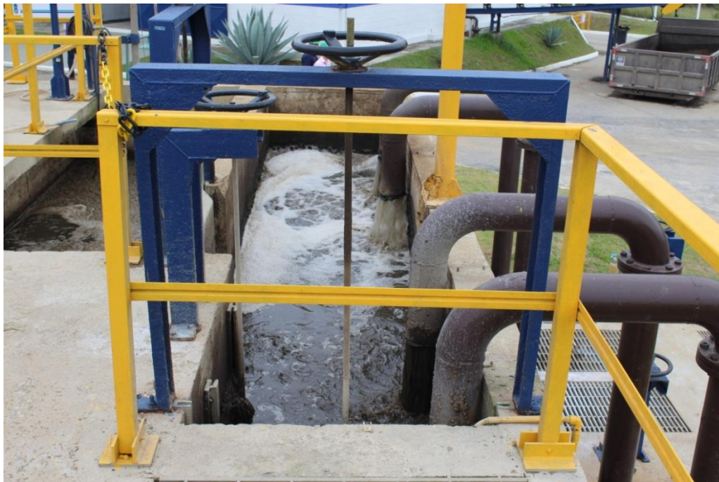
Foto 22 – Elevatória de Esgoto Bruto (vista superior)
