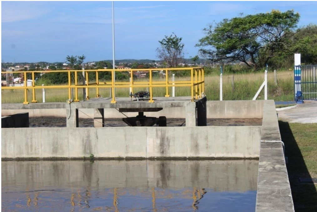
Foto 16 – Tanques de Aeração e Anóxico (vista superior)
