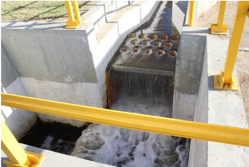
Foto 32 – Saída do Esgoto Tratado
