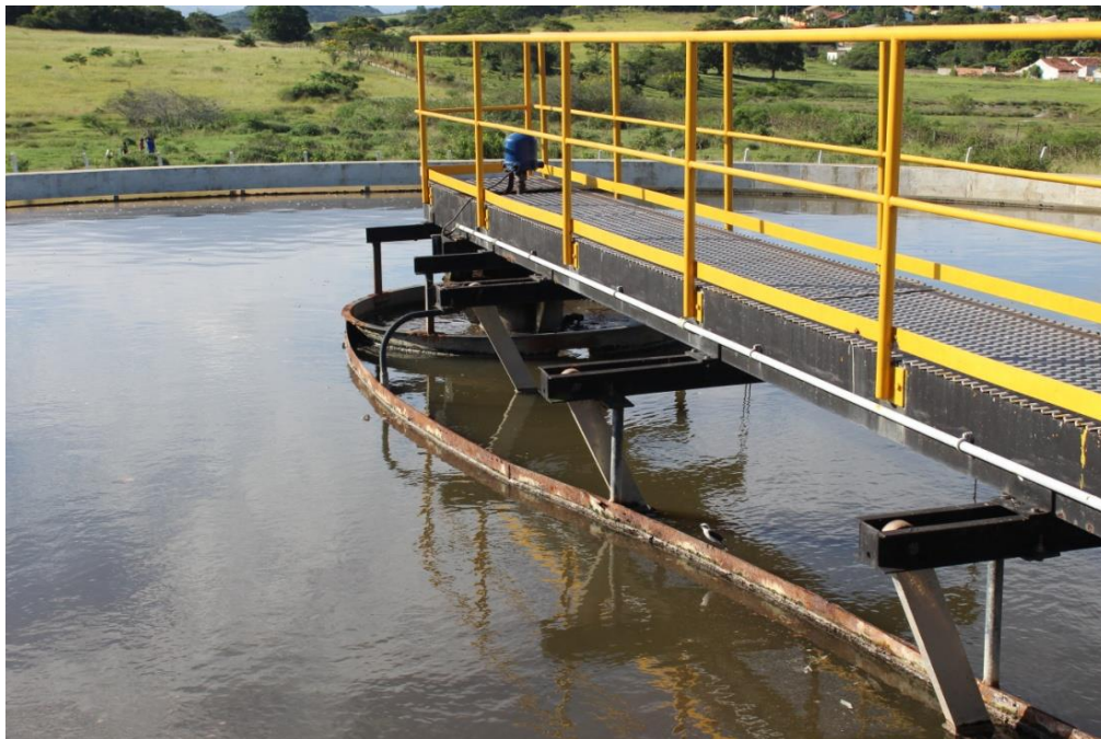
Foto 30 – Decantador (vista superior)
