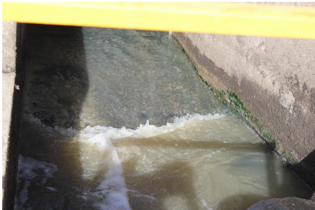
Foto 05 – Entrada do Esgoto In Natura
