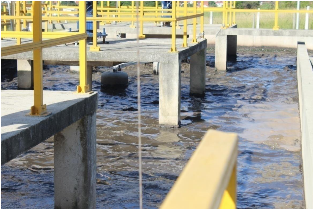
Foto 17 – Tanque de Anóxico (vista superior)
