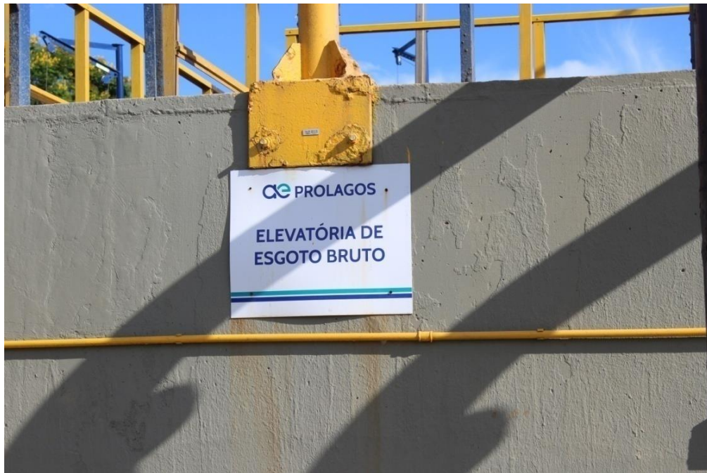
Foto 24 – Elevatória de Esgoto Bruto
