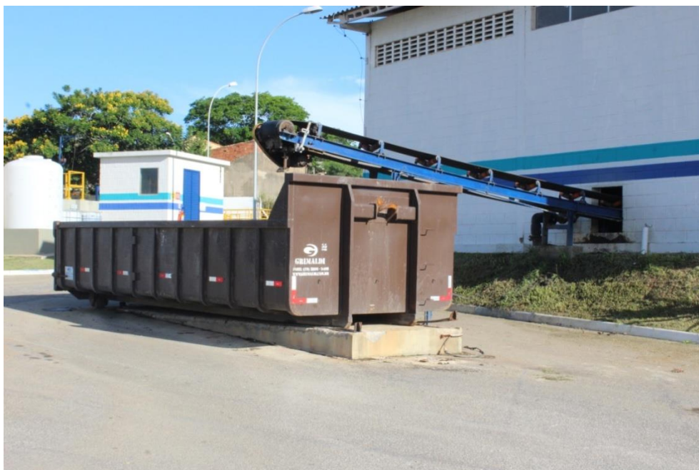
Foto 33 – Esteira de retirada do lodo e lançamento na caçamba
