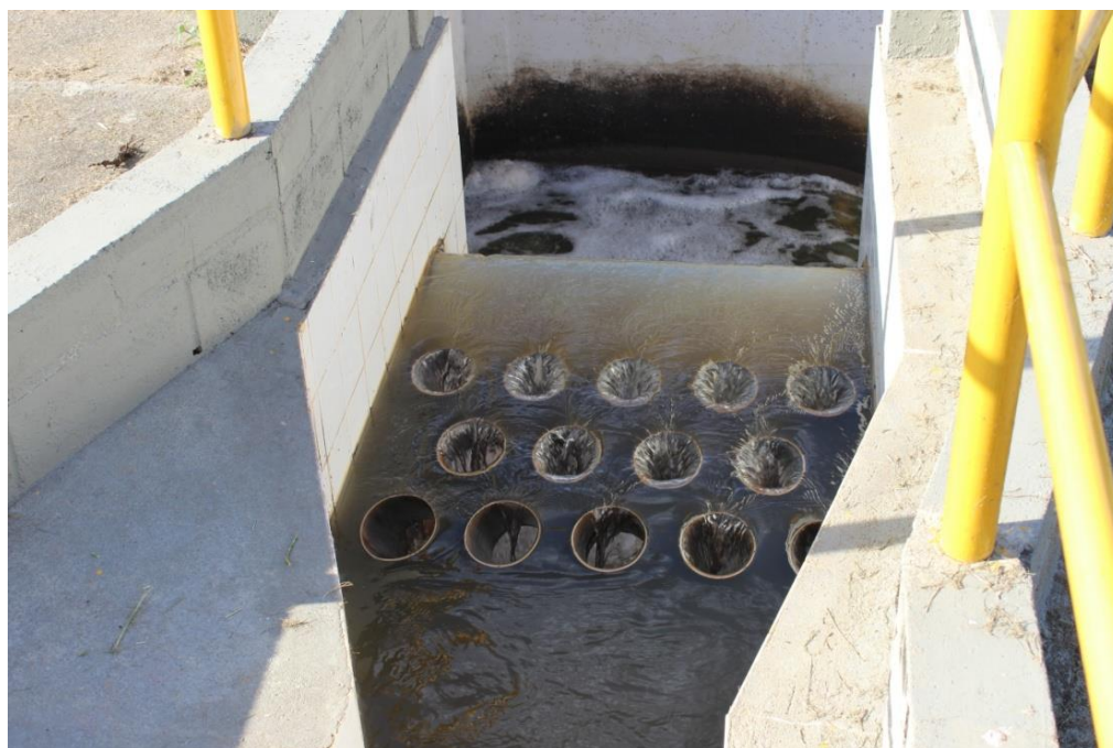
Foto 31 – Saída do Esgoto Tratado
