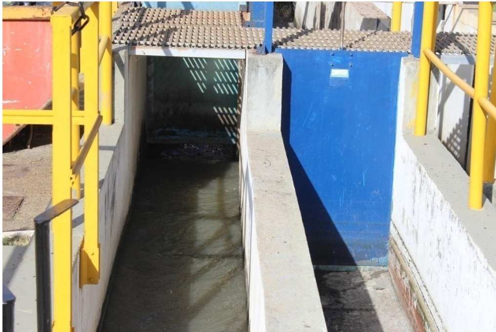
Foto 06 – Entrada do Esgoto In Natura
