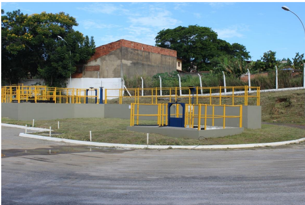
Foto 12 – Medidor de Vazão
