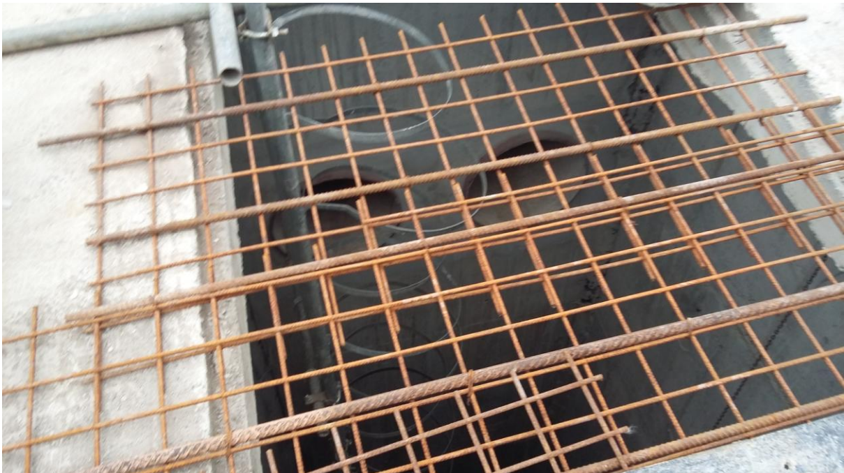
Extravasador da estação elevatória
