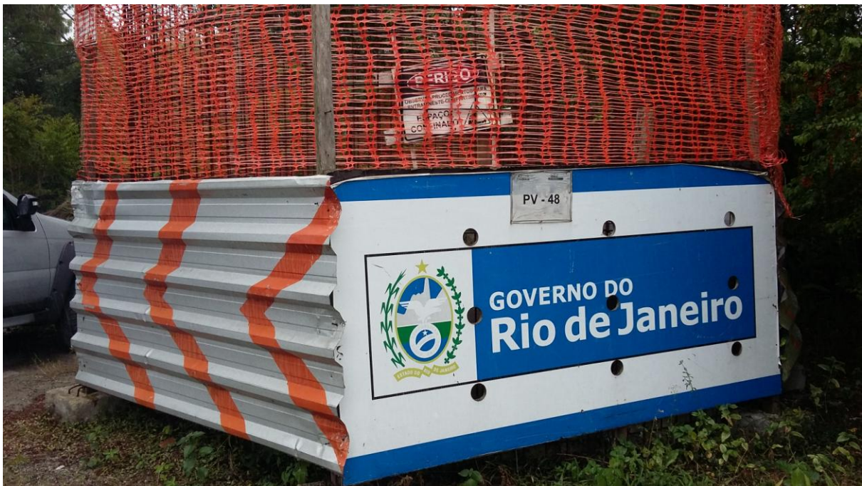
Coletor tronco - PV 48 - obras paralisadas
