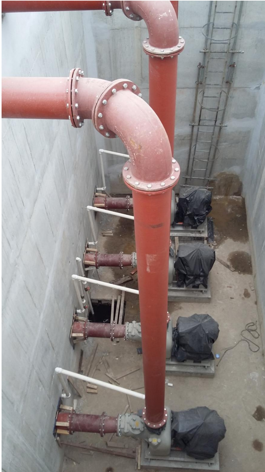
Conjuntos motor-bomba instalados
