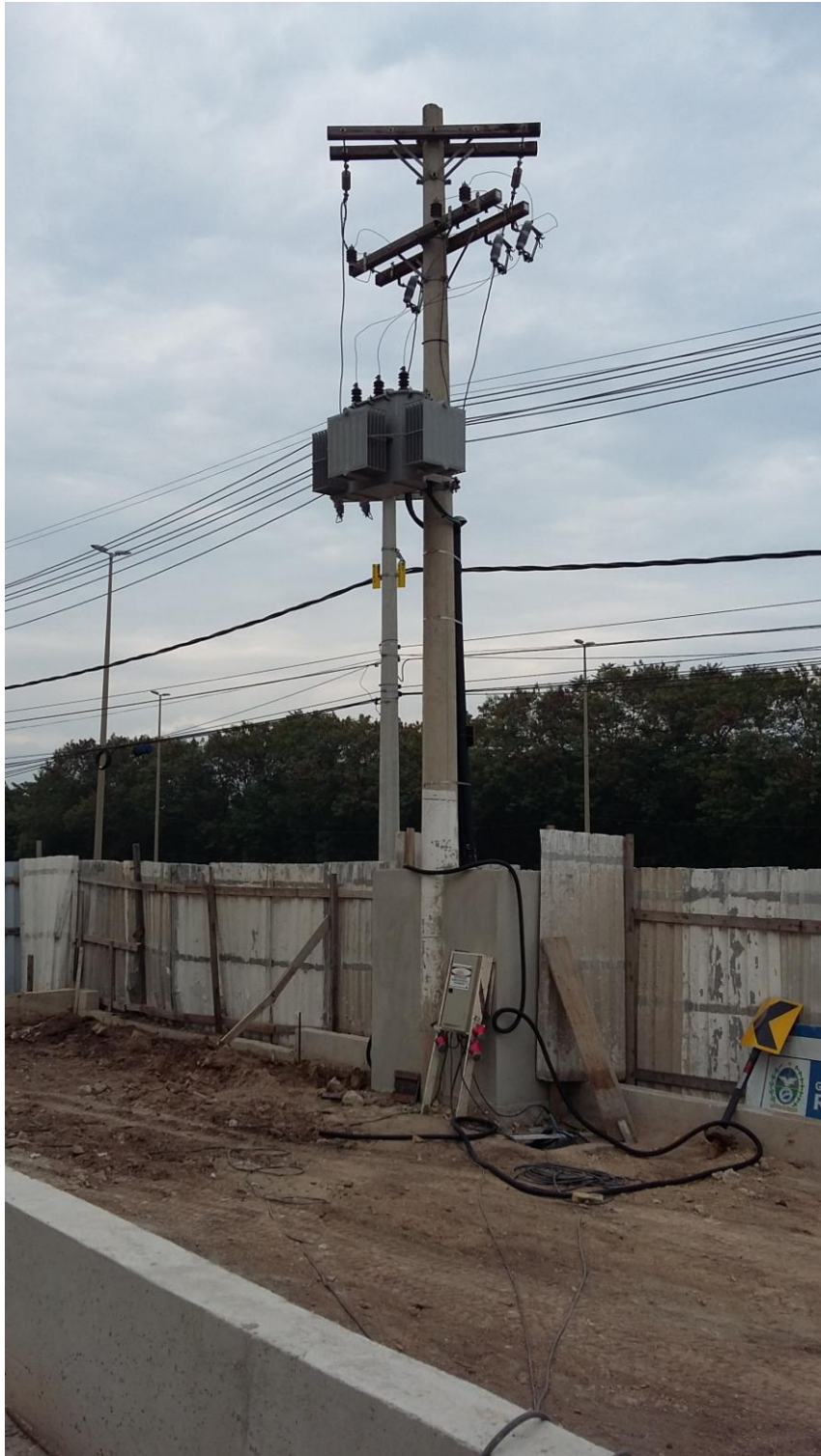
Energização da estação elevatória
