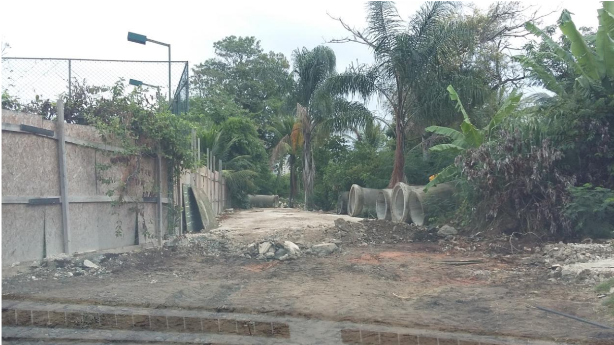
Interferência ao longo do trecho do coletor tronco
