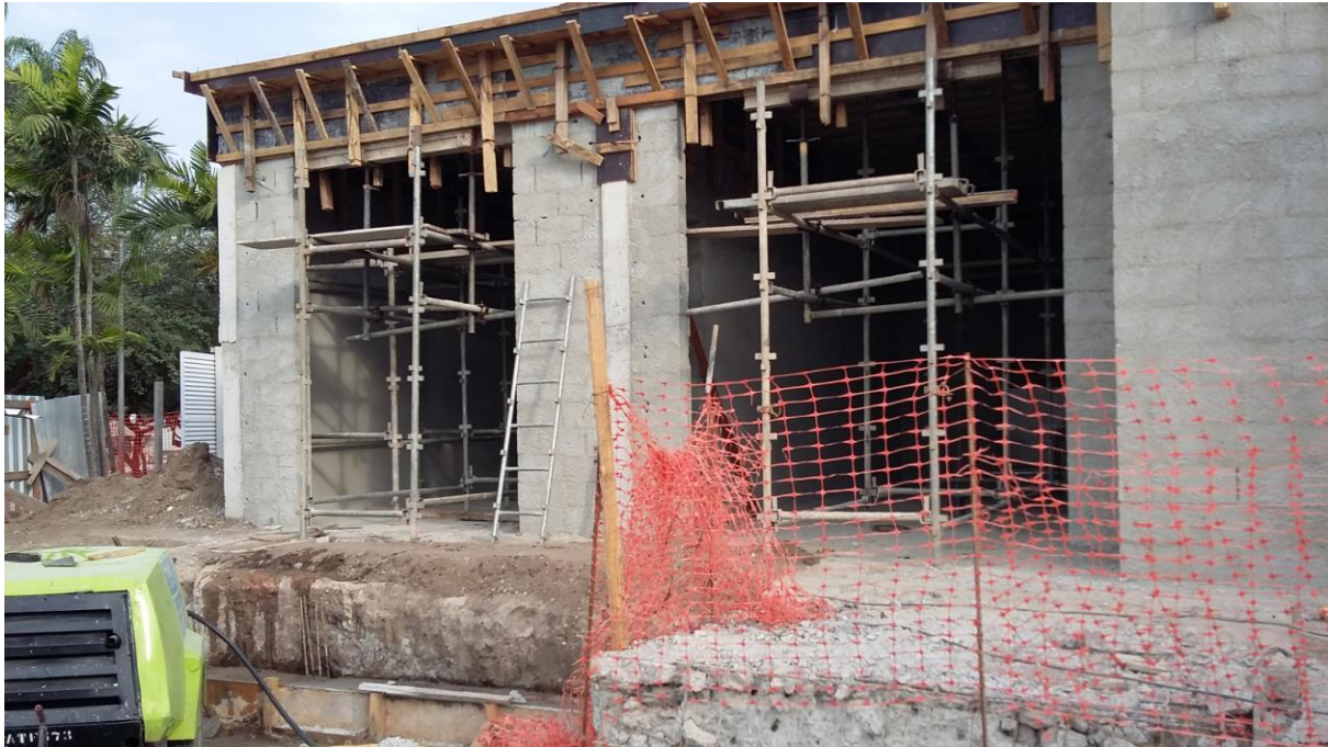
Estrutura para a subestação de energia
