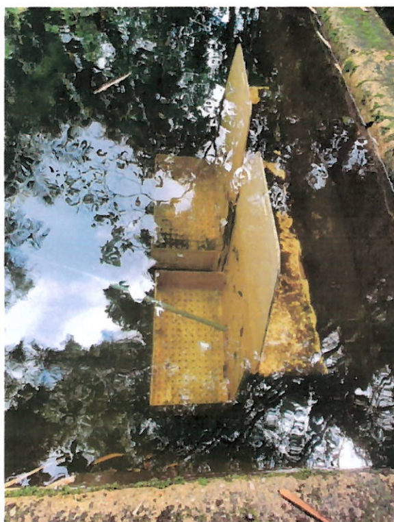
Sistema de gradeamento na saída da UT.
