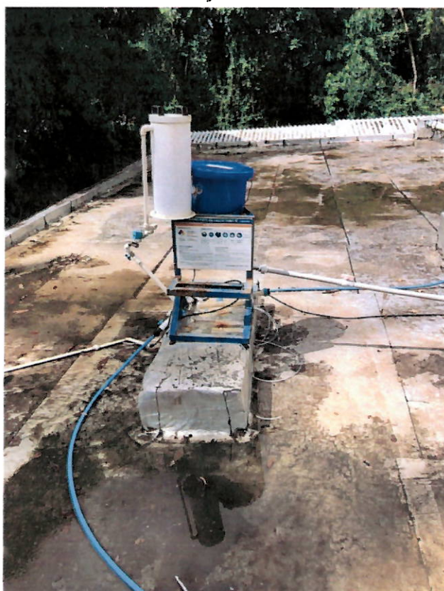
Dosador de cloro do Reservatório
