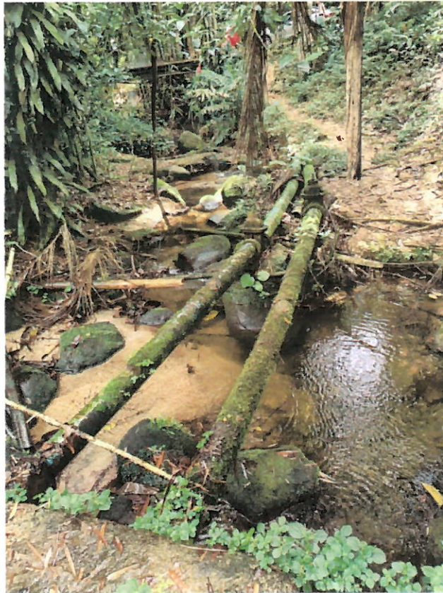
Adutora que sai da UT em direção ao Reservatório do Caborê.
