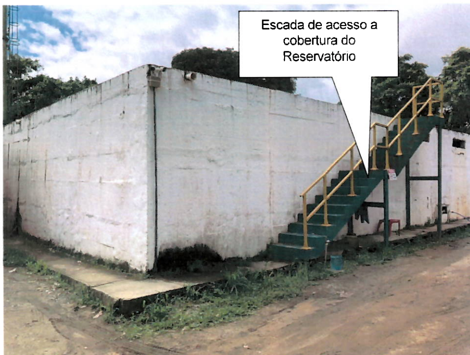
Reservatório do Caborê – 1.000 m 3
