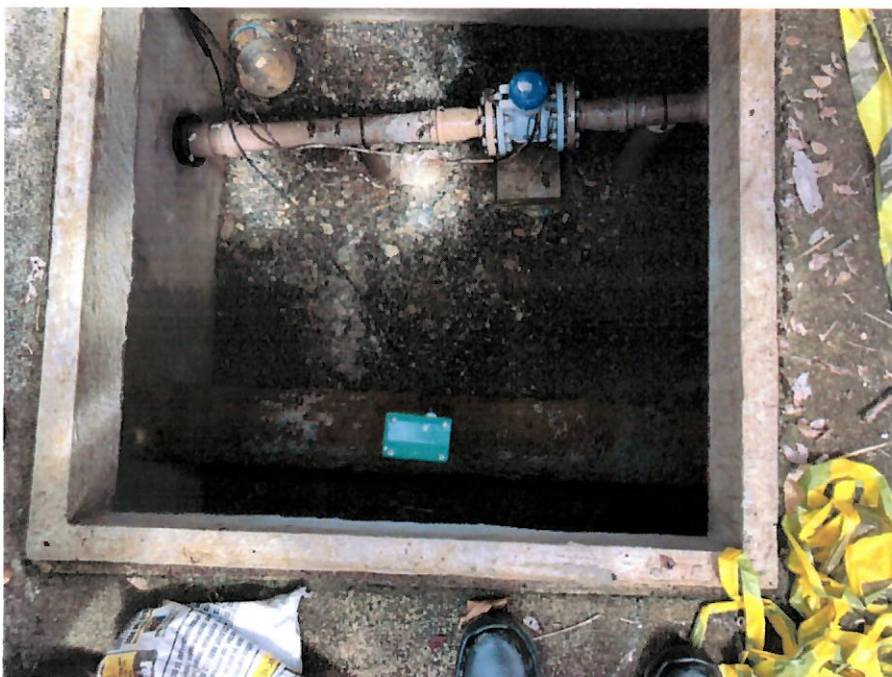
Macromedidores das tubulações de saída do Reservatório
