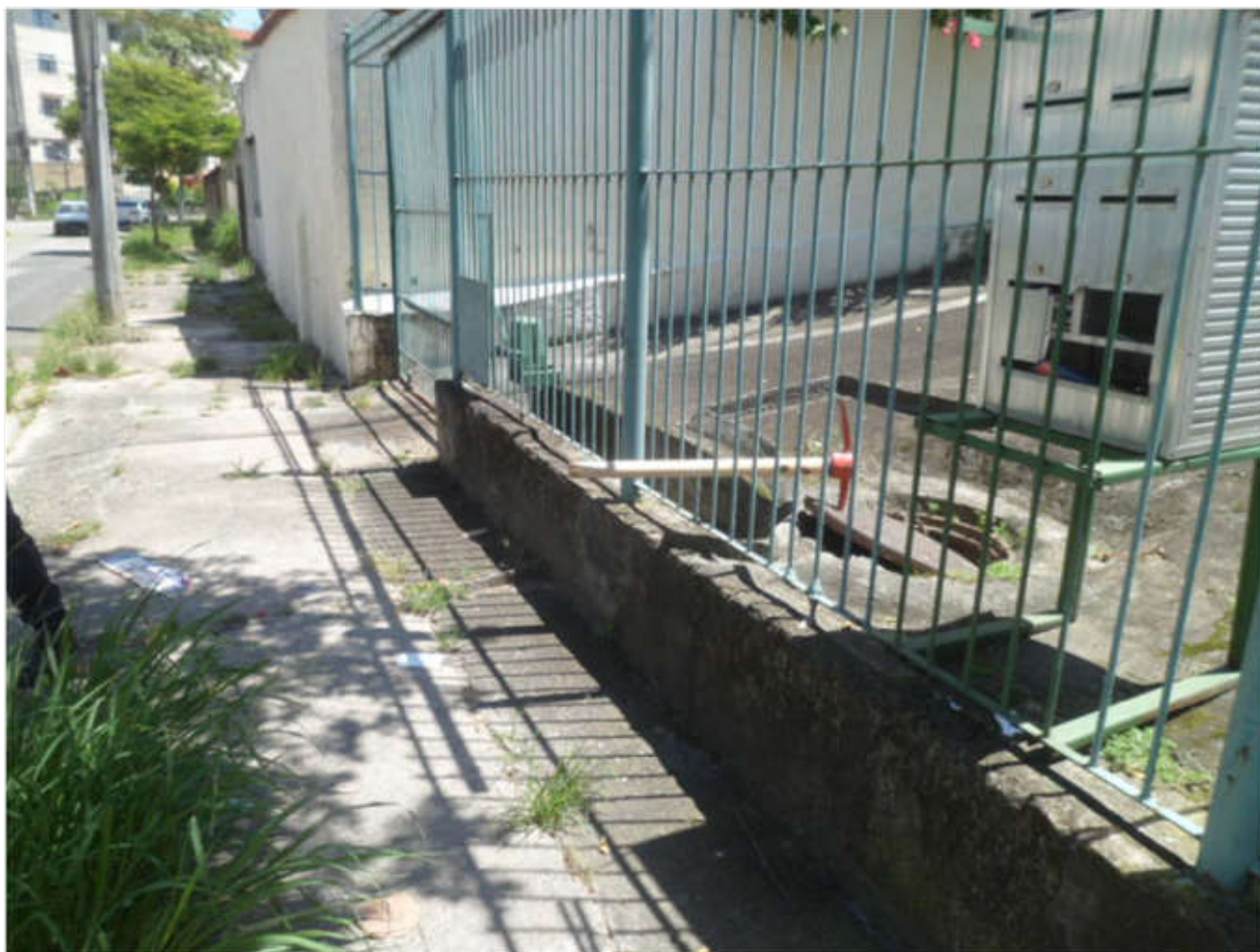
Foto 04 – Poço de Visita (PV) Dentro do Condomínio Cercado por Grades, Ponto de Extravazamento
