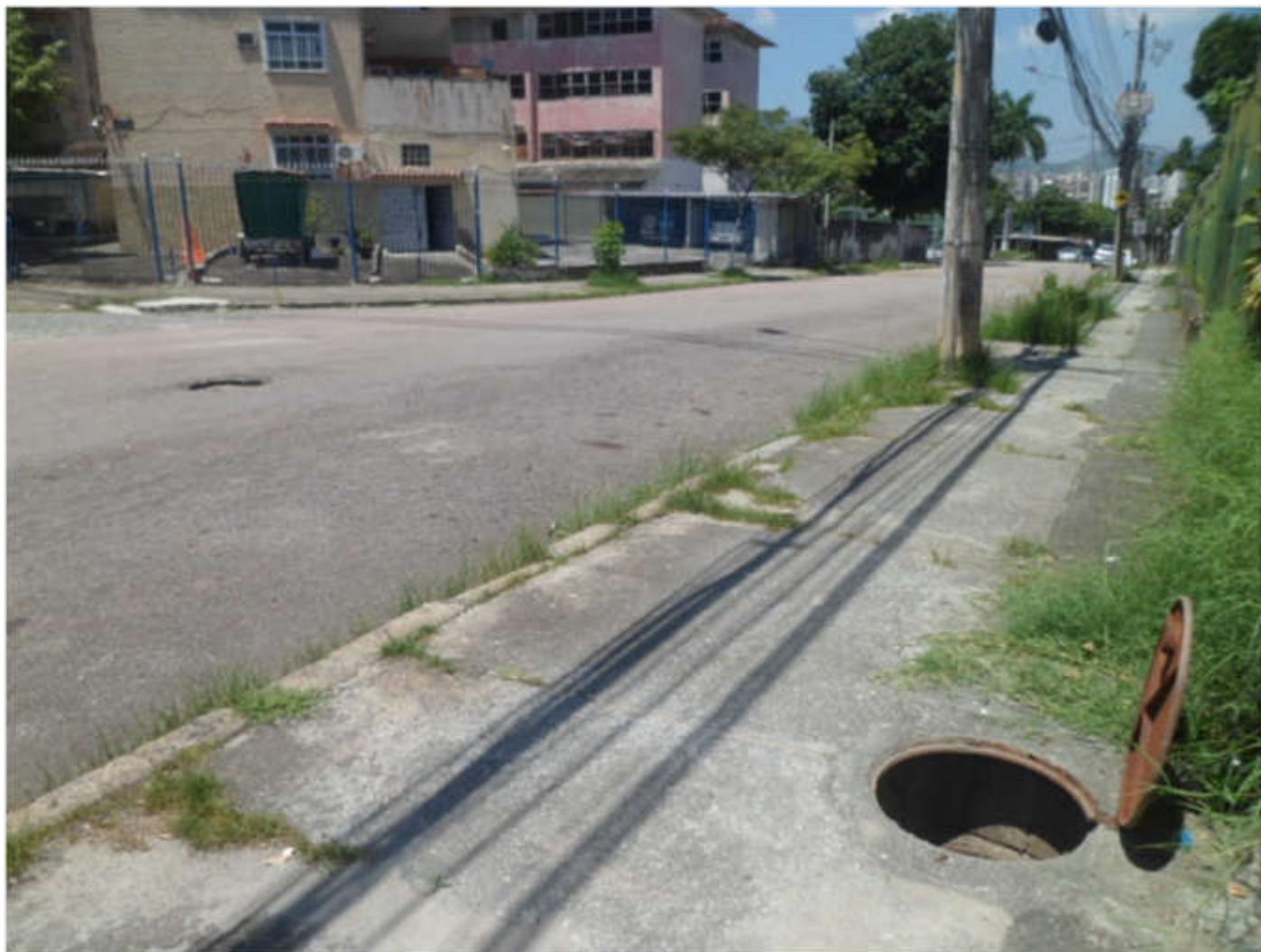
Foto 10 – Coletor, Receptor do Coletor de Esgoto da Rua Rodin
