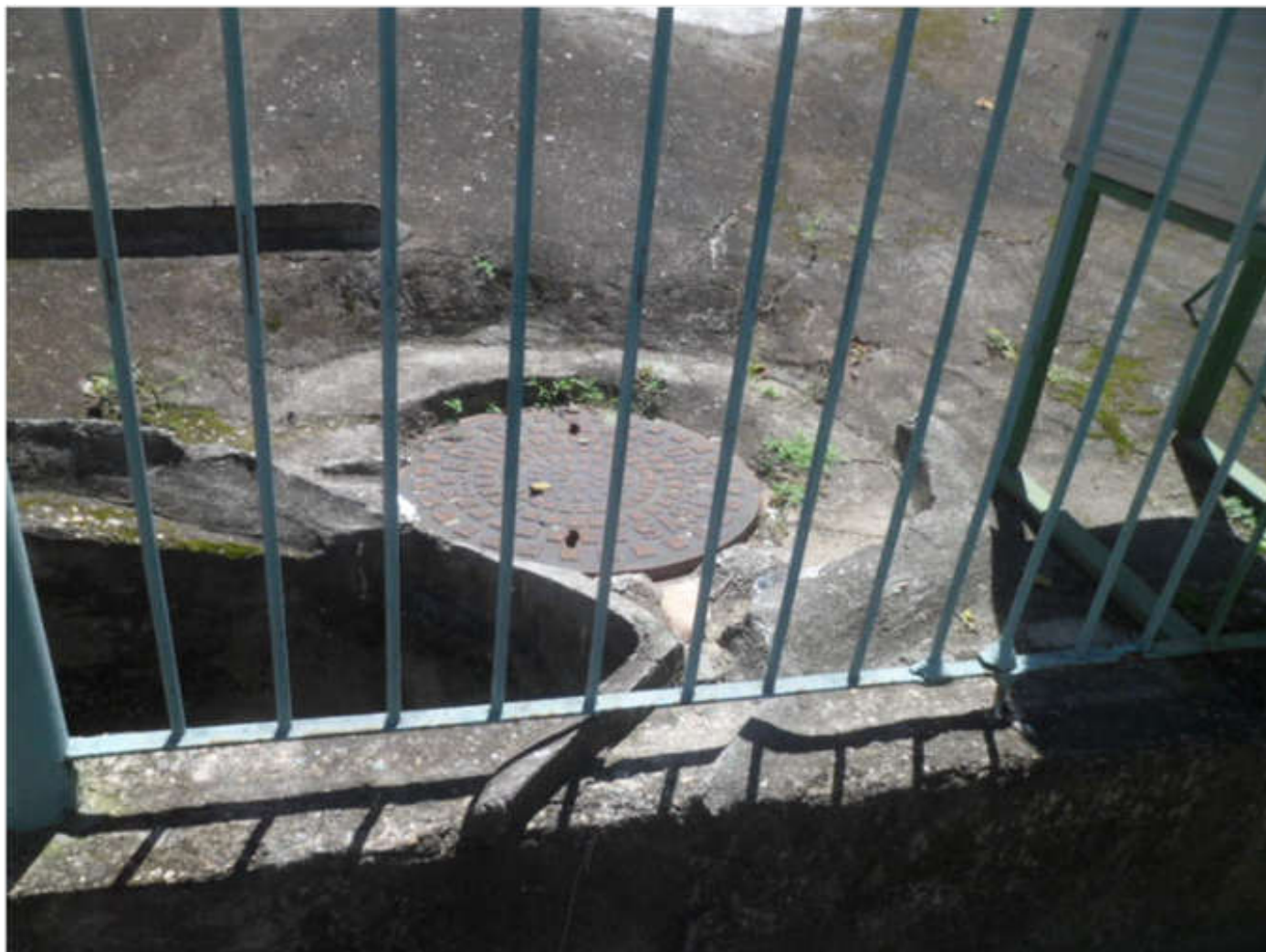
Foto 03 – Poço de Visita (PV) Dentro do Condomínio Cercado por Grades, Ponto de Extravazamento
