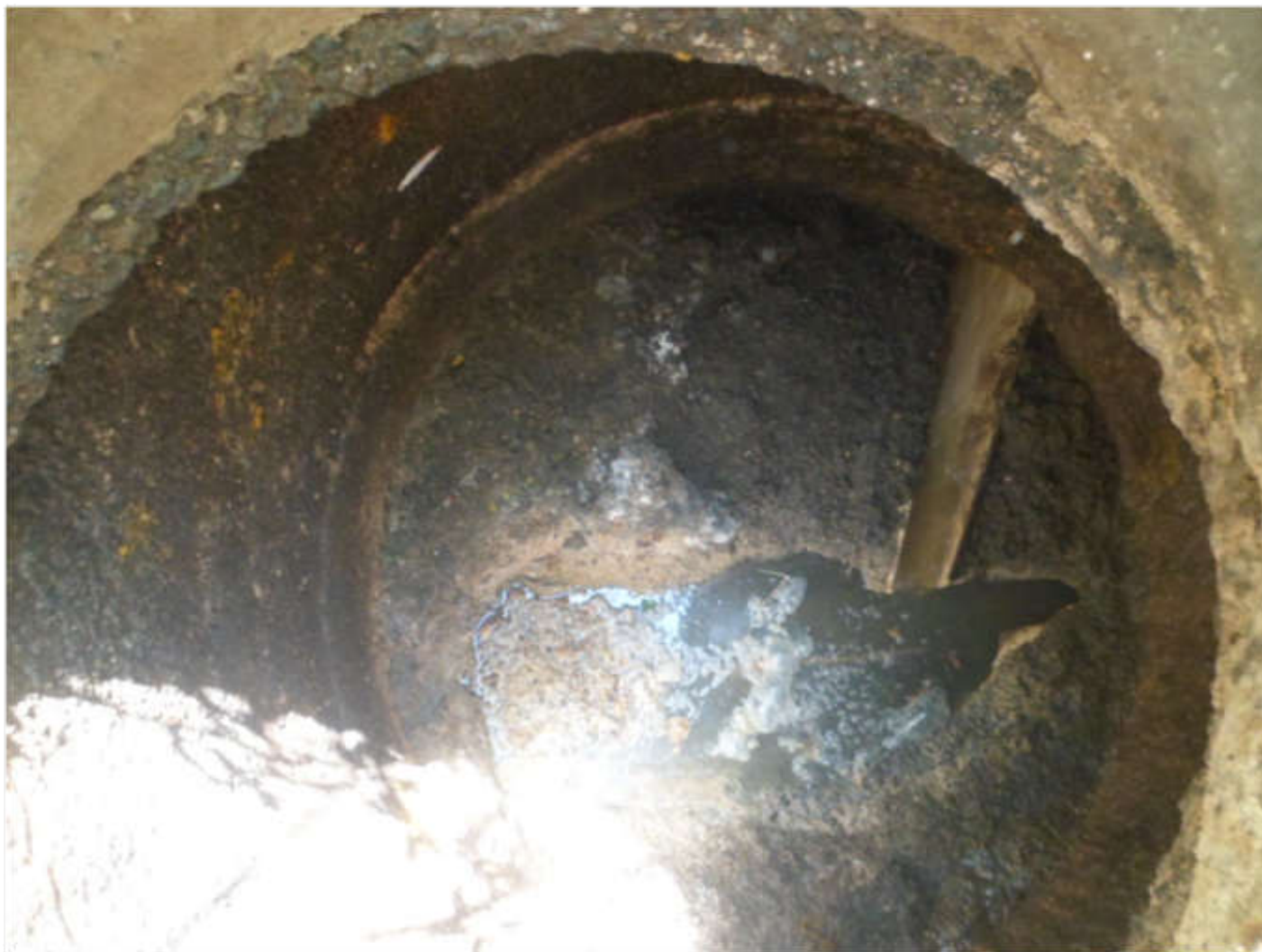
Foto 07 – PV com Acúmulo de Crostas de Gordura
