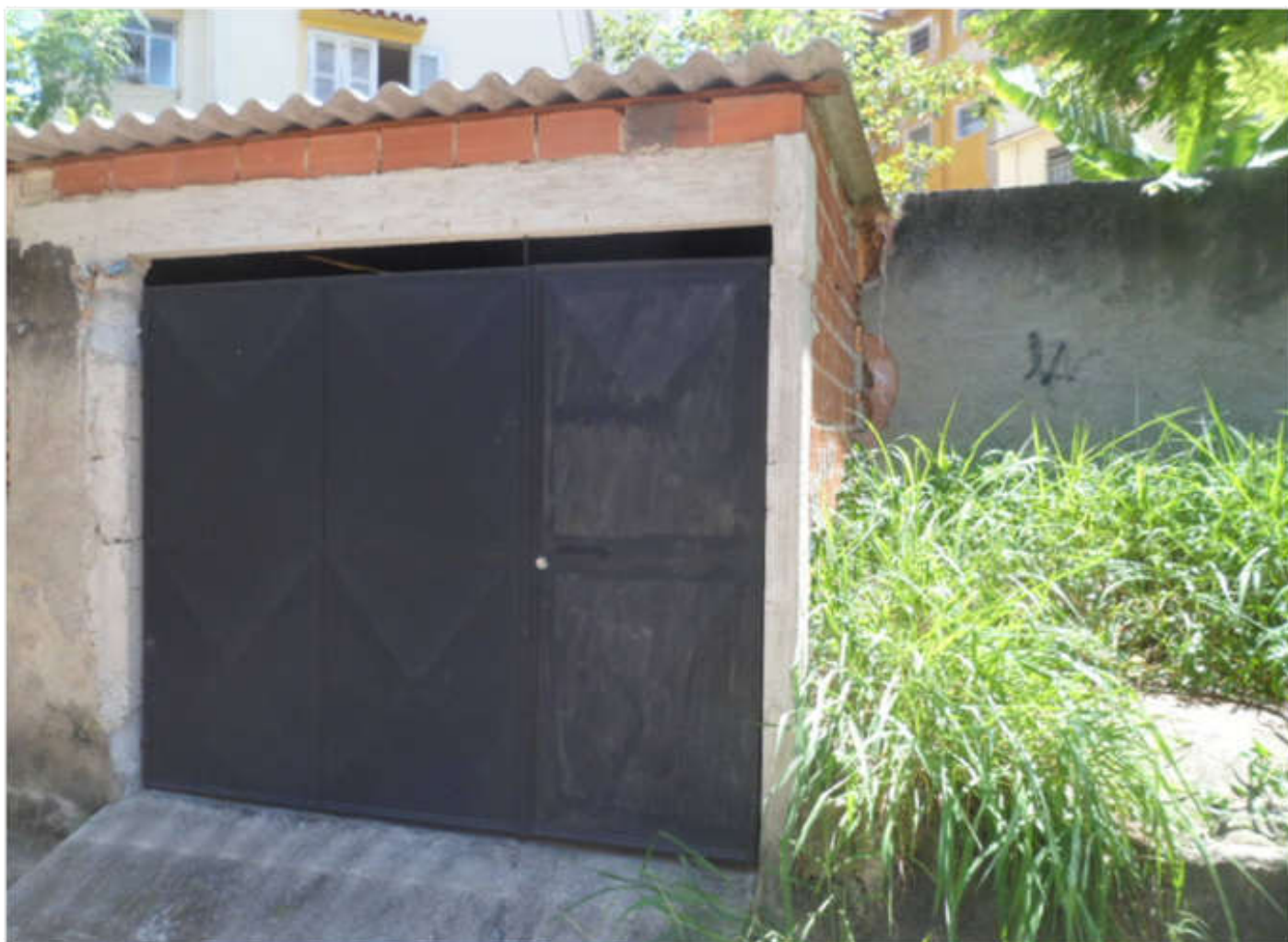
Foto 08 – Construção Irregular sobre a Passagem do Coletor de Esgoto
