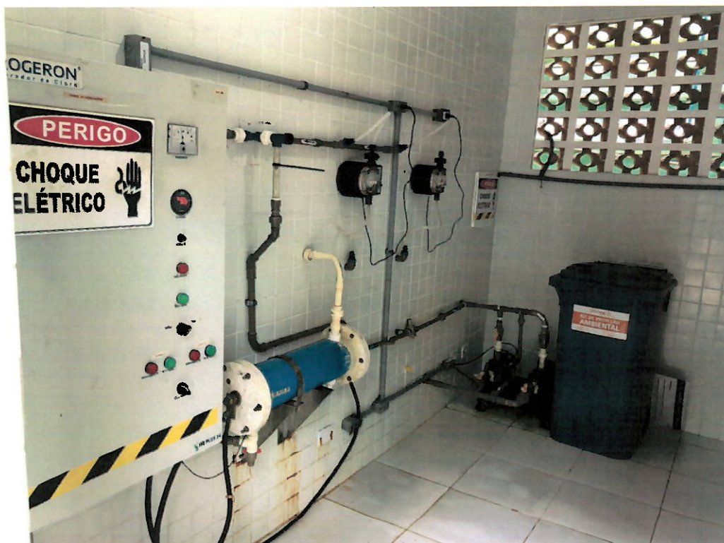
Célula eletrolítica geradora de cloro
