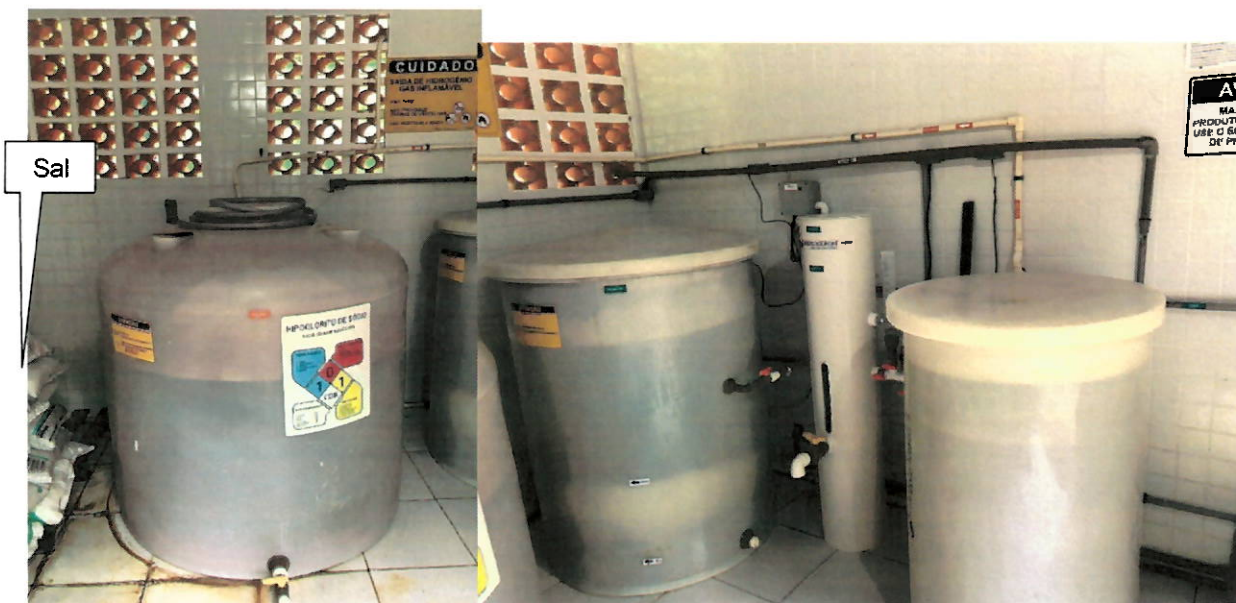
Sistema de armazenagem e dosagem de hipoclorito (ambos sem dique de contenção)
