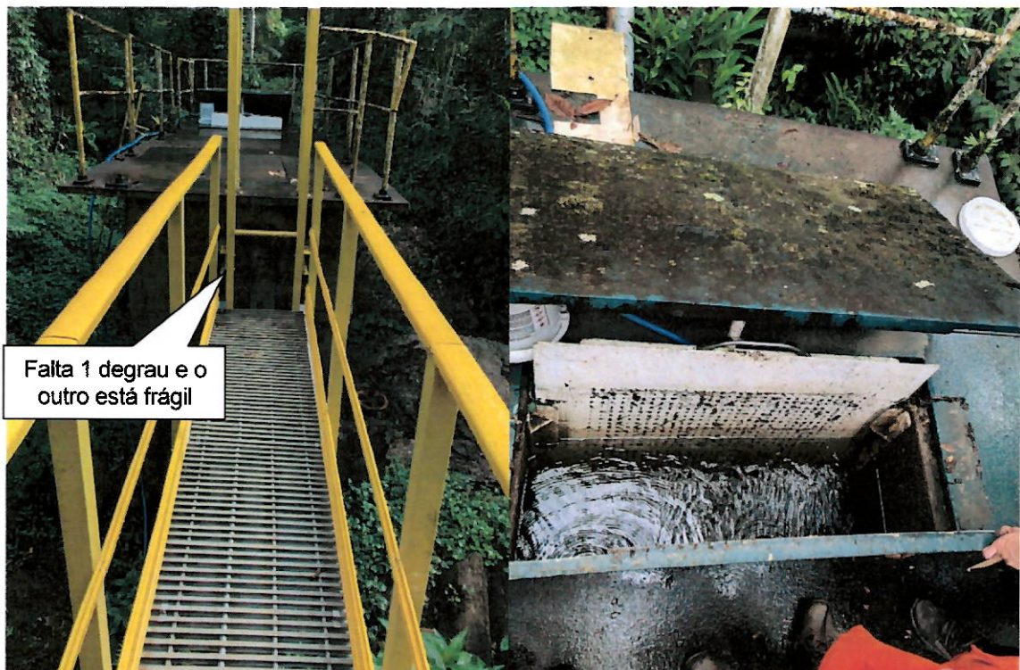
Desarenador e tela para retenção de sólidos
