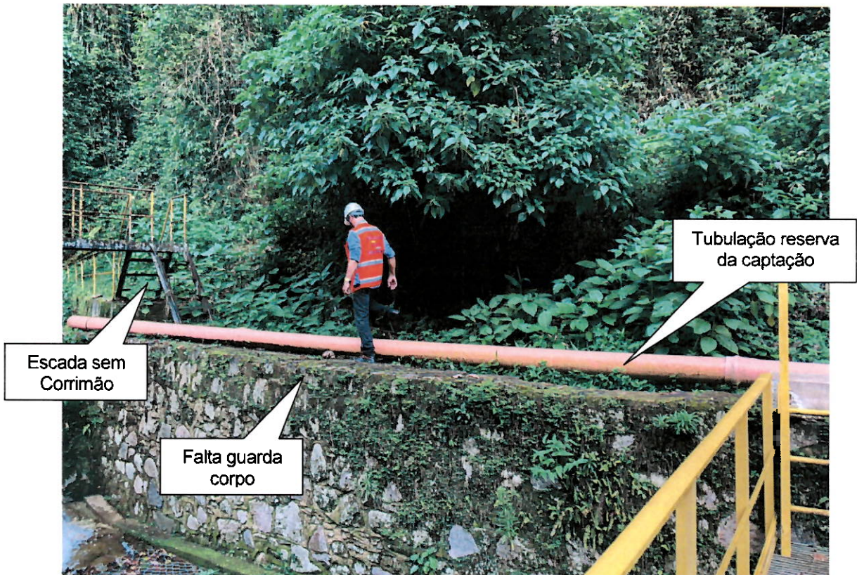
Acesso ao desarenador sem guarda corpo e escada sem corrimão
