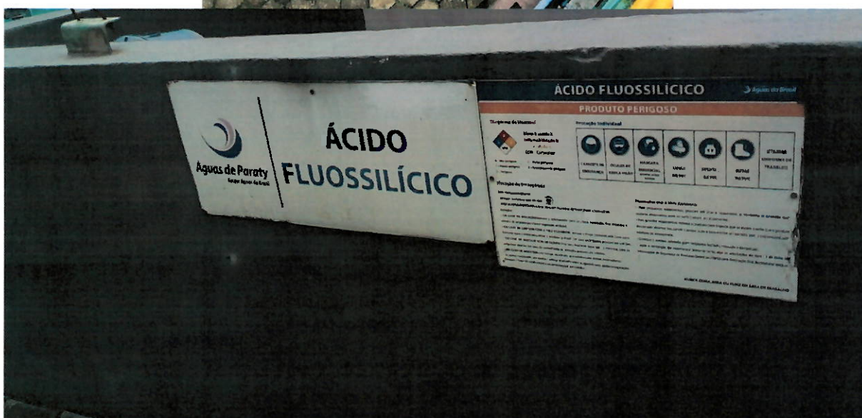
Sistema de armazenagem e dosagem do flúor
