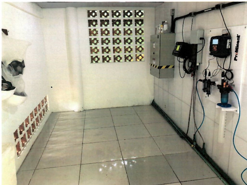
Sistema automático de dosagem do Coagulante
