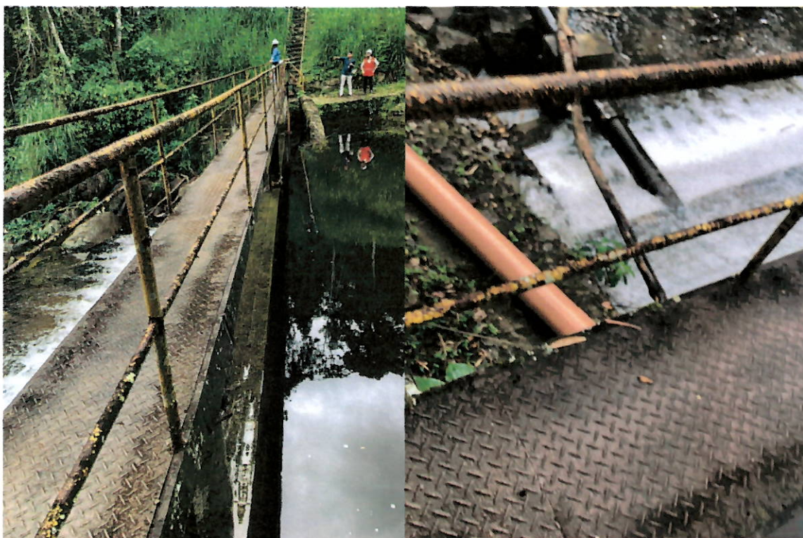
corpo da passarela apresentando pontos de corrosão e falta guarda pé
