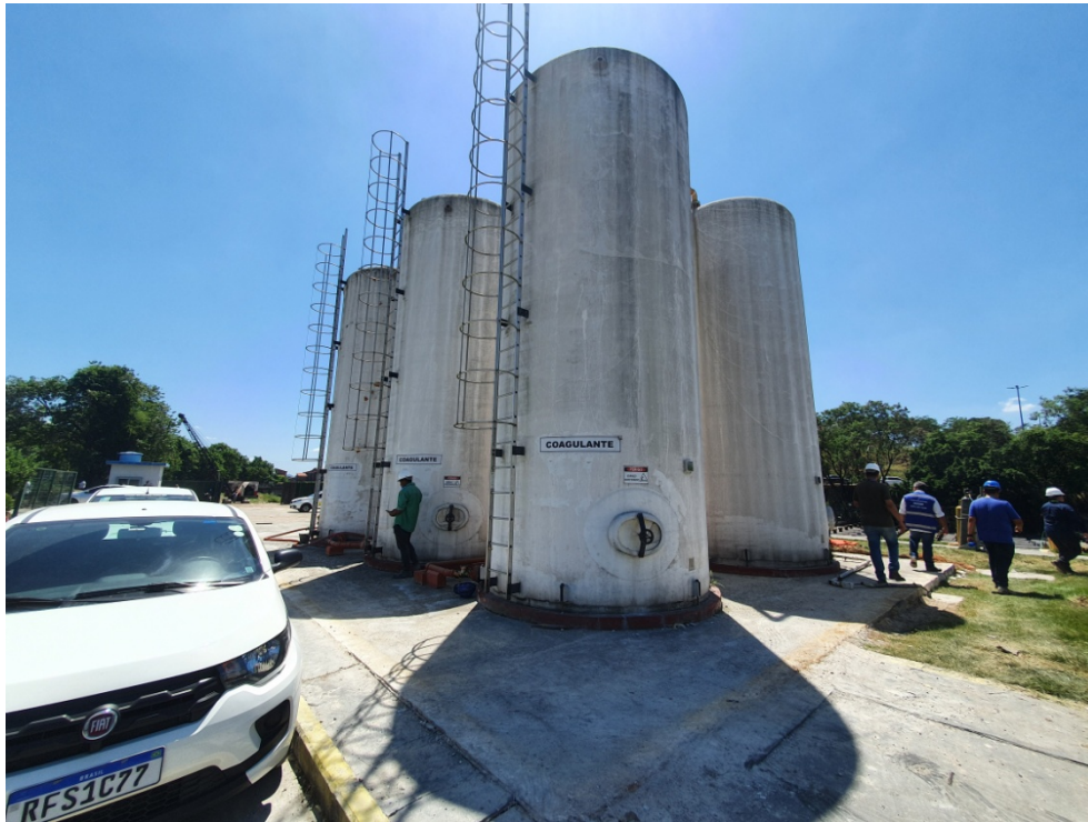
Foto 13 - Silos de armazenamento de coagulantes
