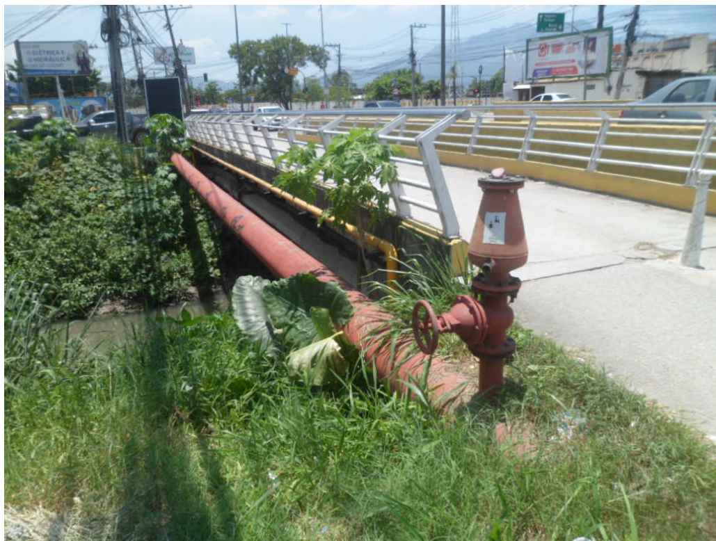
Foto 03 – Válvula de Manobra da Rede de Esgoto (sem presença de vazamento)
