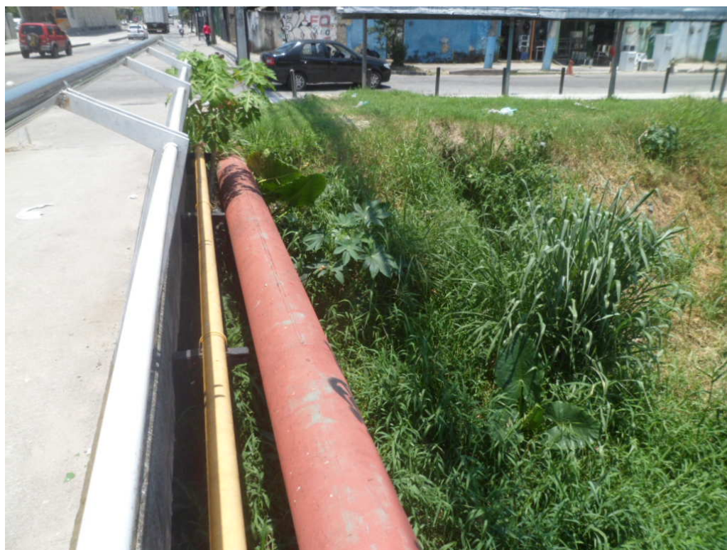
Foto 02 – local do Possível Rompimento da Rede Coletora (sem presença de vazamento)
