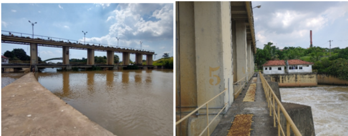
Foto 04 - Comportas de regularização de nível e descarga de água bruta
