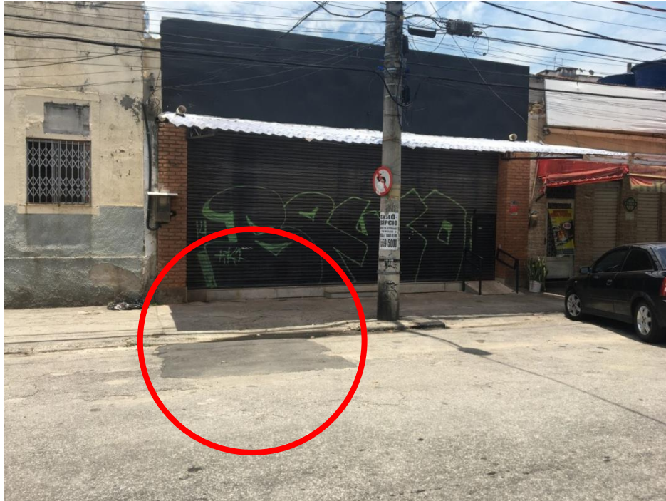
RUA ALMIRANTE JOÃO CÂNDIDO BRASIL, 245 - REPARO NO DETALHE EM VERMELHO
