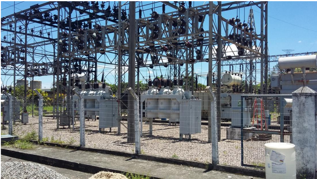
VISTA GERAL DA SUBESTAÇÃO PRINCIPAL DA ETA GUANDU - APÓS O INCÊNDIO
