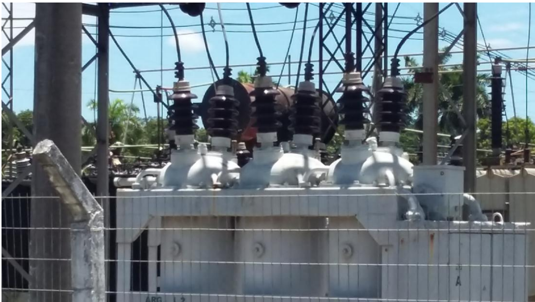
TRANSFORMADOR DANIFICADO - AO FUNDO
