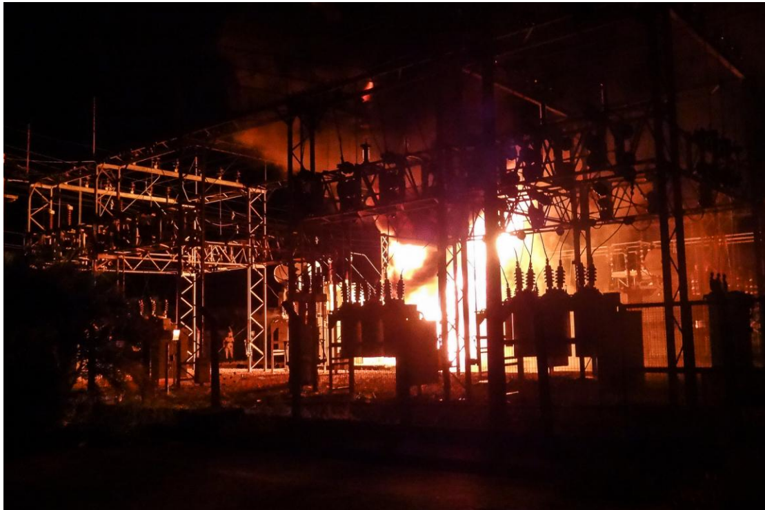
INCÊNDIO NO TRANSFORMADOR 2 DA SUBESTAÇÃO PRINCIPAL DA ETA GUANDU
