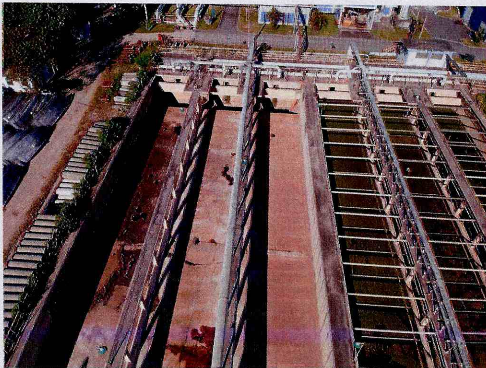
Figura 11 – Limpeza das Células do Decantador
