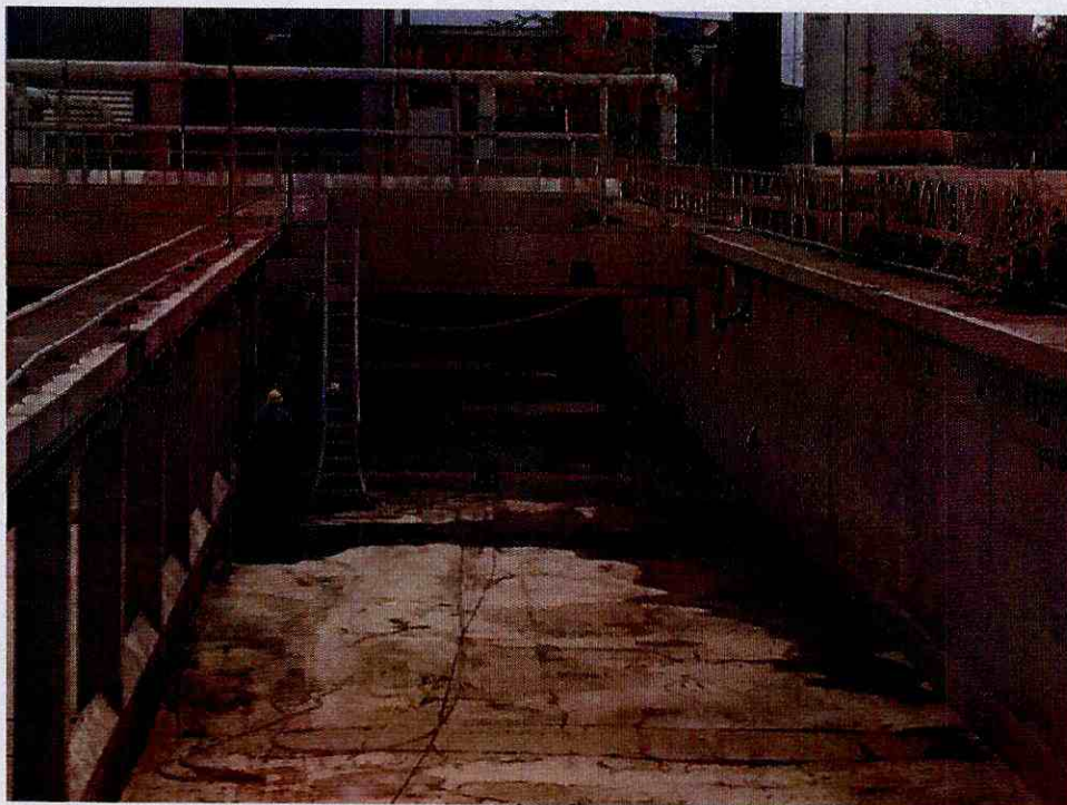
Figura 10 – Limpeza das células do Decantador
