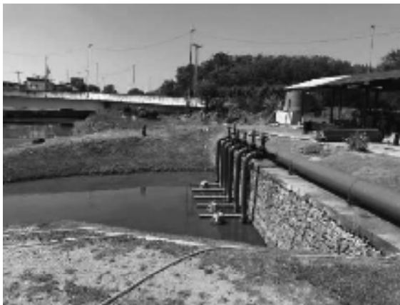
Figura A.15 – Sistema de bombeamento da água a jusante da ETR para reciclo, sendo injetada no processo junto ao sistema de microaeração.
