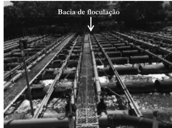
Figura A.6 – Etapa de floculação a partir da adição de polímero catiônico (floculante) associada à aeração, aplicados através de sistemas instalados na plataforma flutuante a jusante da bacia de coagulação.
