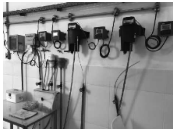
Figura A.24 – Aparelhos eletrônicos utilizados para a dosagem dos produtos químicos utilizados na ETR. Foi informado durante a vistoria que estes equipamentos encontram-se inoperantes e que a dosagem está sendo feita de forma manual.
