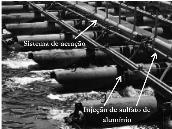
Figura A.5 – Detalhe dos sistemas de aeração e de injeção de coagulante instalados na plataforma flutuante na entrada da bacia de coagulação.
