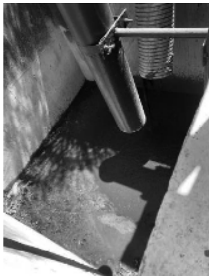
Figura A.17 – Poço que recebe a parcela semi-sólida do lodo flotado removido do leito do rio, após passagem pela peneira estática, de onde é bombeado para a rede coletora de esgoto operada pela CEDAE.
