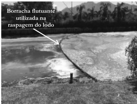
Figura A.11 – Processo de raspagem superficial do lodo flotado feito por uma estrutura de borracha flutuante. Nota-se que parte do lodo ainda permanece na bacia de flotação após a raspagem.
