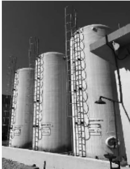
Figura A.21 – Tanques de armazenamento de coagulante utilizado na ETR.
