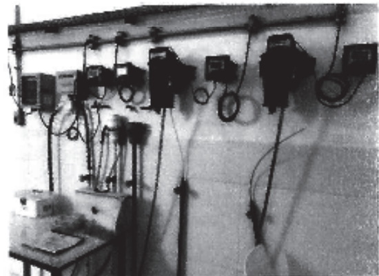
Figura A.24 – Aparelhos eletrônicos utilizados para a dosagem dos produtos químicos utilizados na FTR. Foi informado durante a vistoria que estes equipamentos encontram-se inoperantes e que a dosagem está sendo feita de forma manual.
