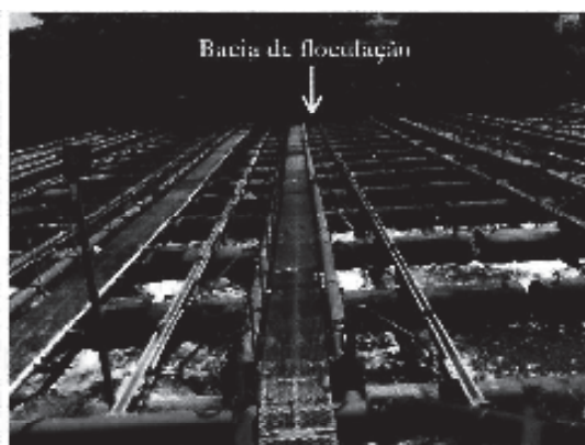
Figura A.6 – Linha de floculação a partir da adição de polímero catiônico (floculante) associada à aeração, aplicados através de sistemas instalados na plataforma flutuante a jusante da bacia de coagulação.
