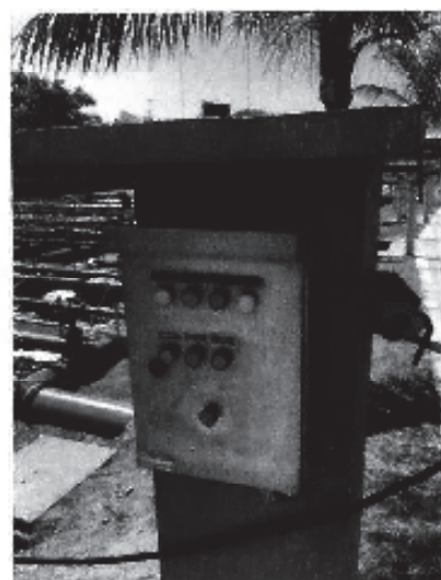
Figura A.8 – Painel de controle do sistema de aeração.
