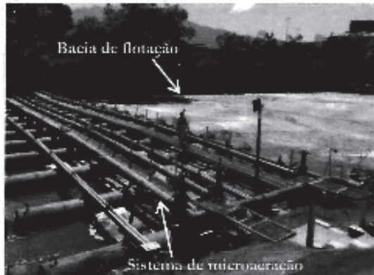
Figura A.9 – Etapa de flotação auxiliada por sistema de microaeração instalado na plataforma flutuante a jusante da bacia de coagulação.
