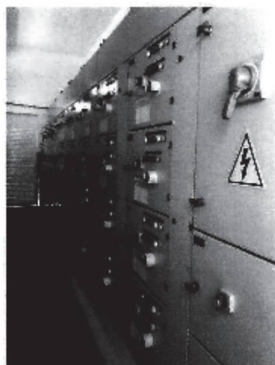
Figura A.18 – Sala de controle das rodas de dragagem.
