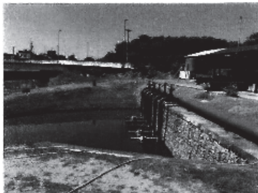
Figura A.15 – Sistema de bombeamento da água a jusante da ETR para reciclo, sendo injetada no processo junto ao sistema de microaeração.
