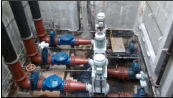
Área interna do salão de bombas
