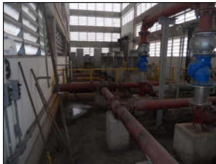
Área interna da elevatória de retorno de lodo
