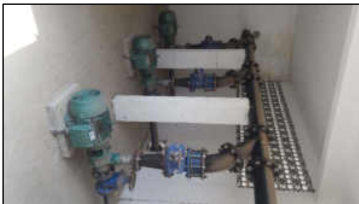
Salão de bombas
