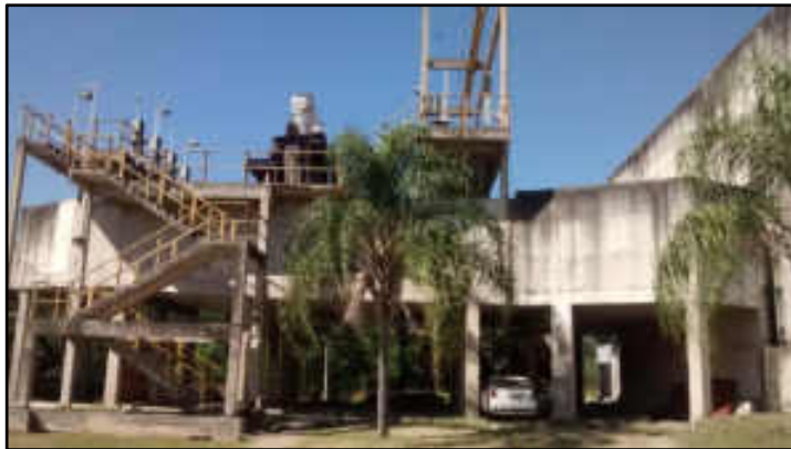
Vista geral - gradeamento fino
