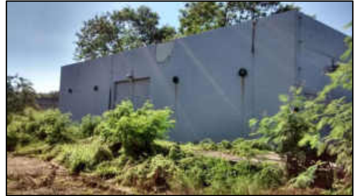
Subestação elétrica secundária
