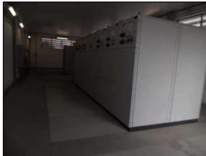
Área interna do prédio dos sopradores - sala de painéis
