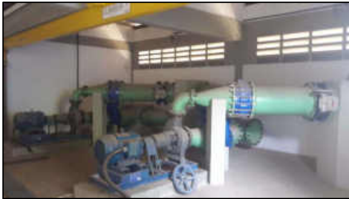
Estação elev de lavagem de filtro - recirculação
