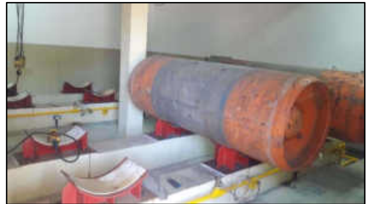
Casa de cloração
