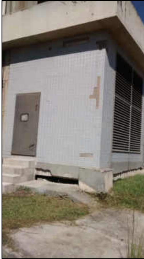
Sala dos exaustores
