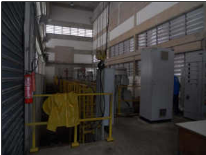
Área interna da elevatória de retorno de lodo
