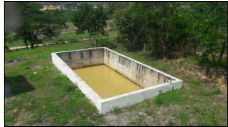
Tanque - lavagem de filtro
