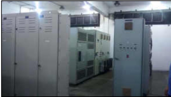
Sala de painéis
