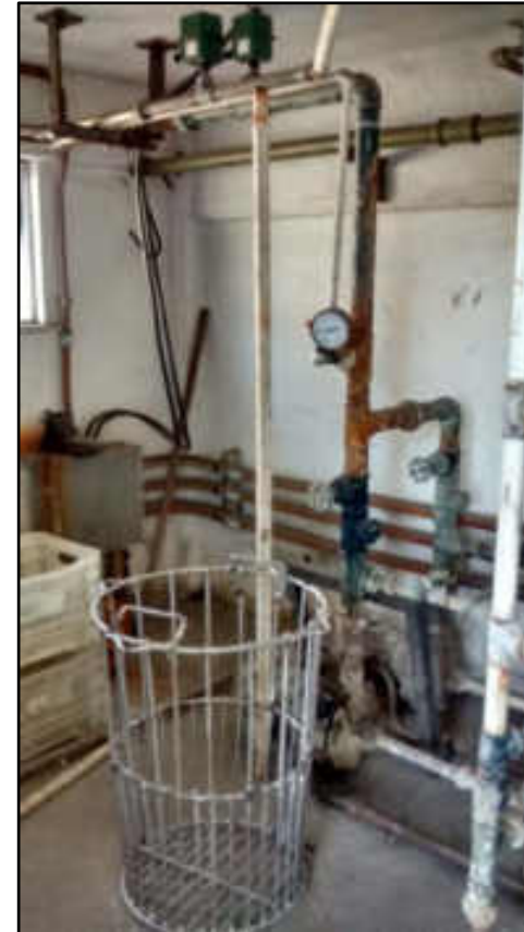
Área interna da casa de bombas de selagem e lavagem
