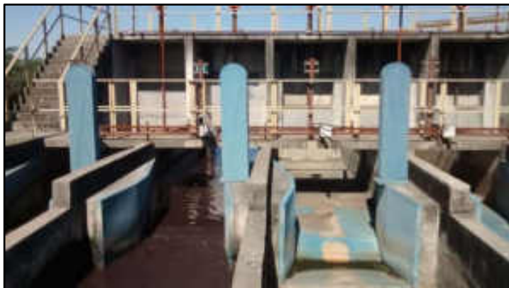
Calha parshall afluente primário
