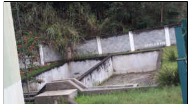
Área de secagem de lodo - desativada
