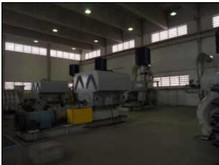
Sala do sopradores
