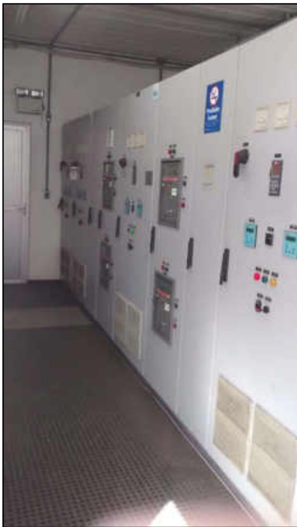
Sala de painéis
