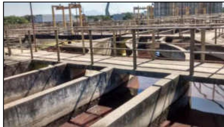
Calha parshall afluente primário
