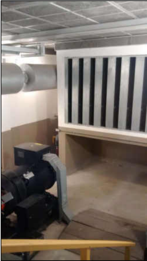
Prédio principal sala do gerador
