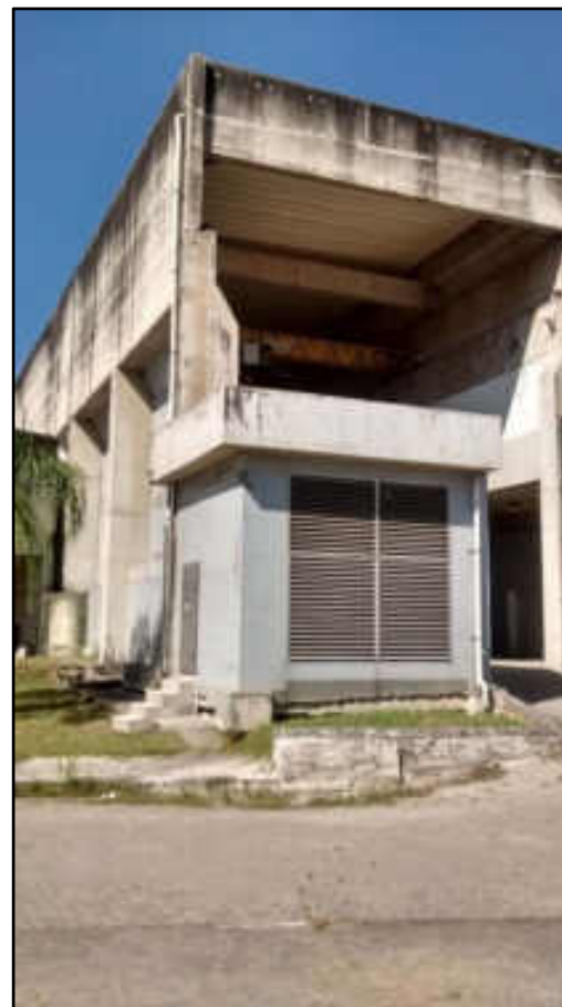
Sala dos exaustores
