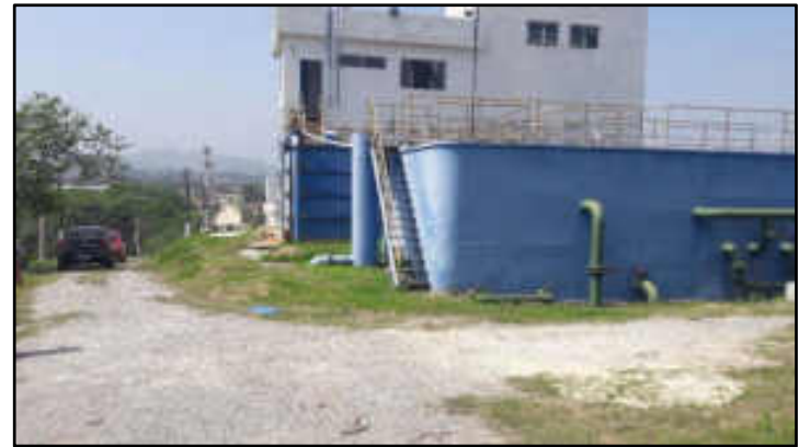
Vista geral da ETA
