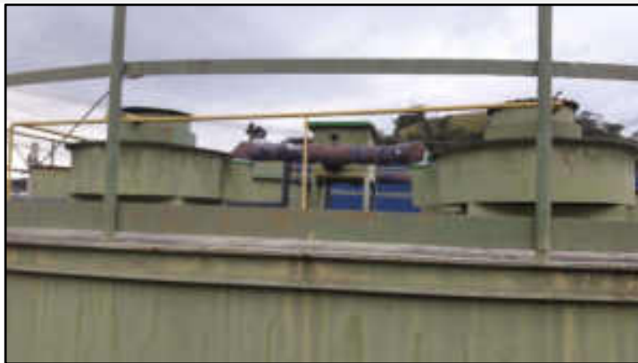
Parte superior do tanque de decantação
