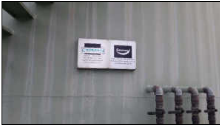
Placa do construtor
