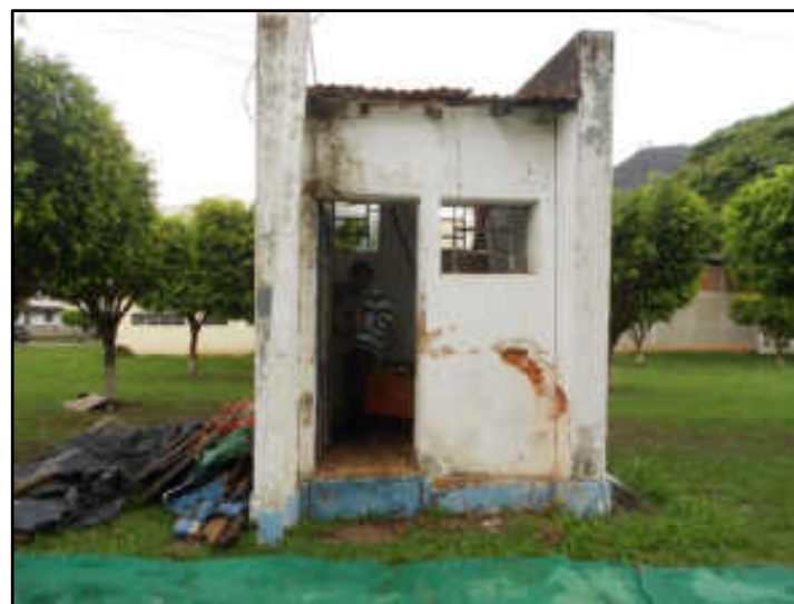
Casa de comando da bomba do poço artesiano de Ourânia, Natividade
