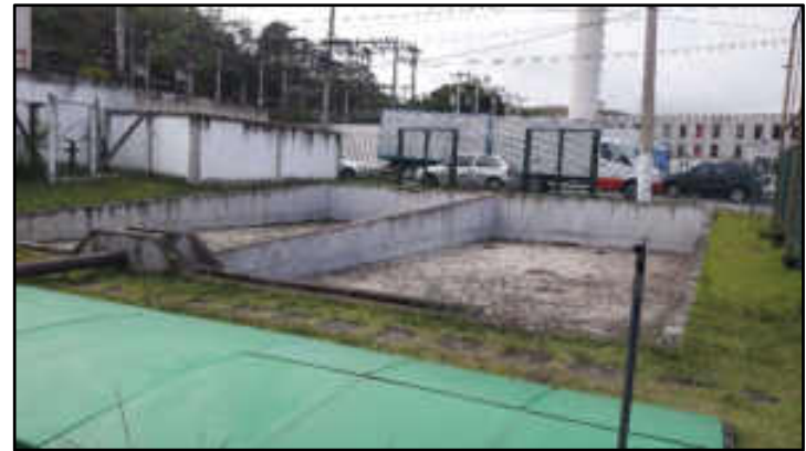
Tanques de armazenamento de lodo
