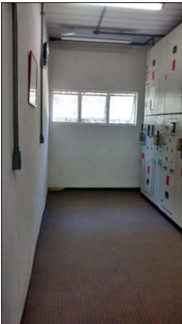
Área interna da subestação
