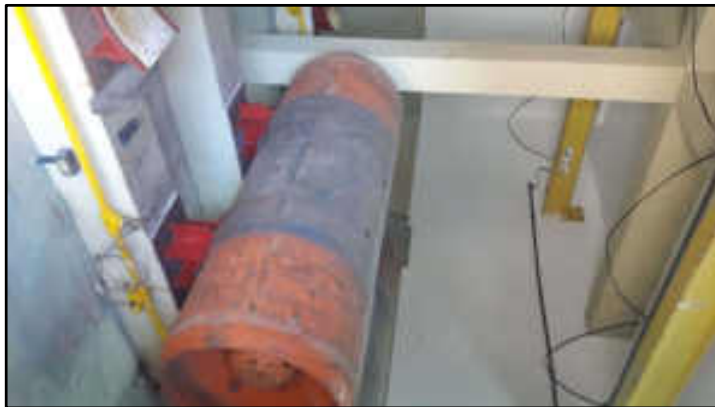
Casa de cloração
