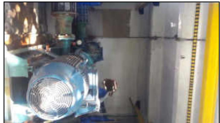
Salão de bombas
