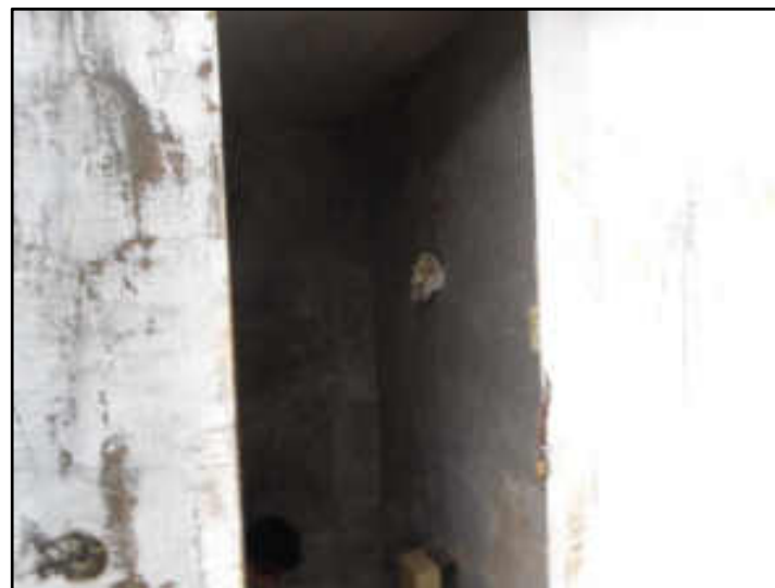
Vista interna do booster de Ourânia, Natividade
