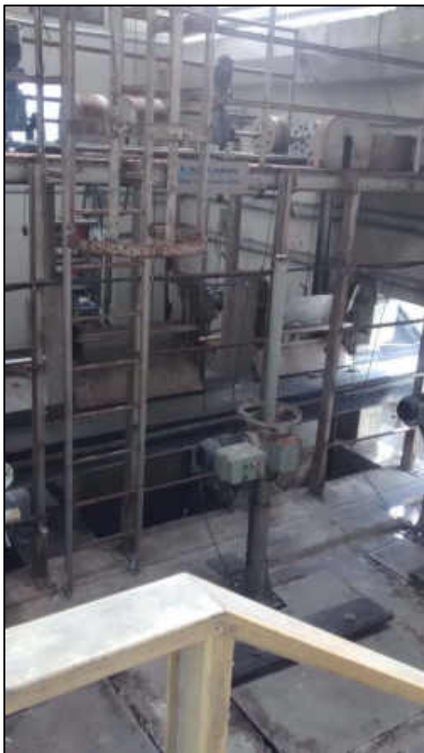
Área interna da sala de gradeamento grosseiro
