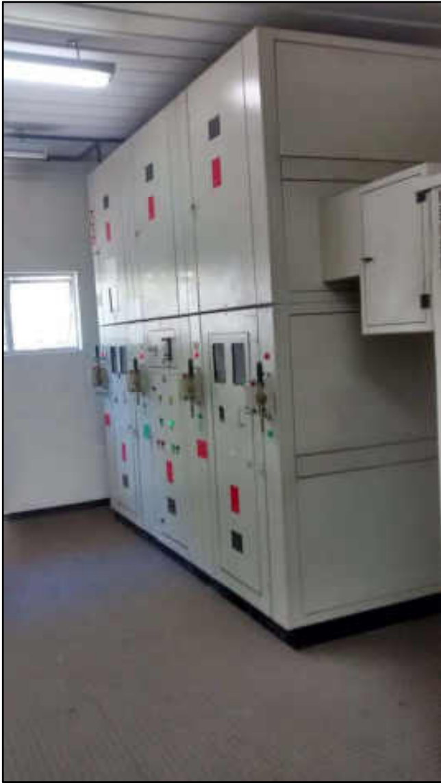
Área interna da subestação
