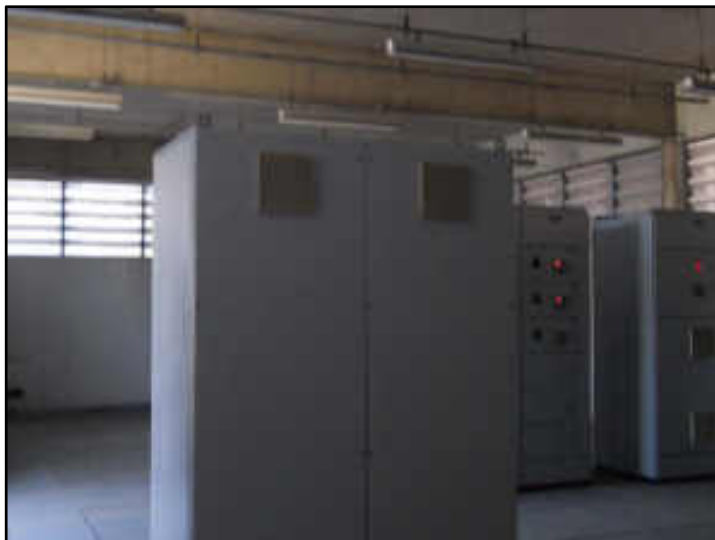
Sala de painéis
