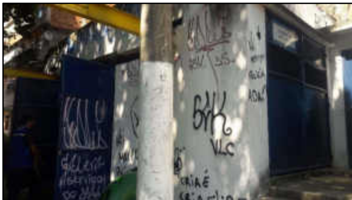
Vista de entrada da subestação elétrica
