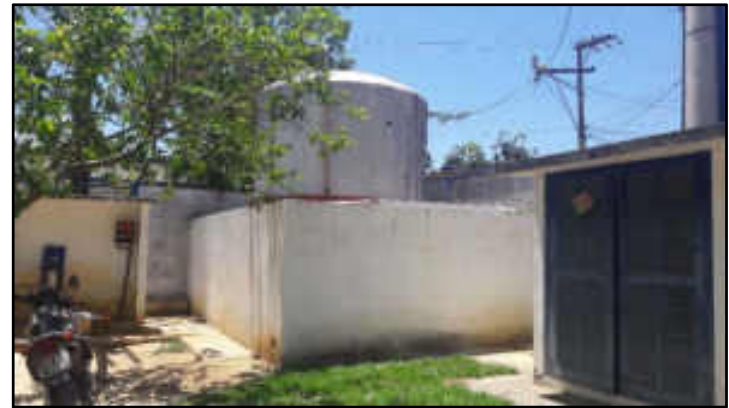
Reservatório de sulfato de alumínio
