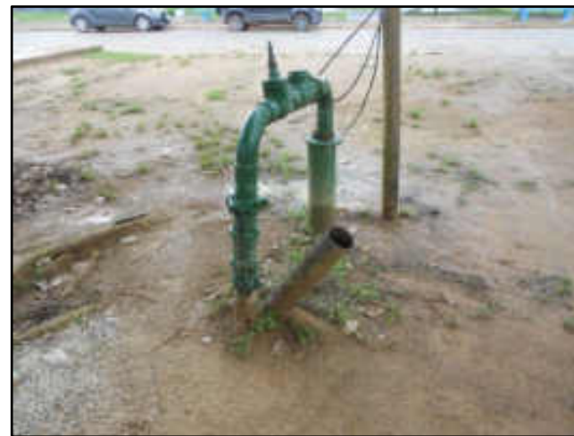
Cavalete do poço artesiano de Ourânia, Natividade
