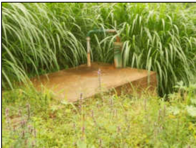
Cavalete da captação de Ourânia, Natividade
