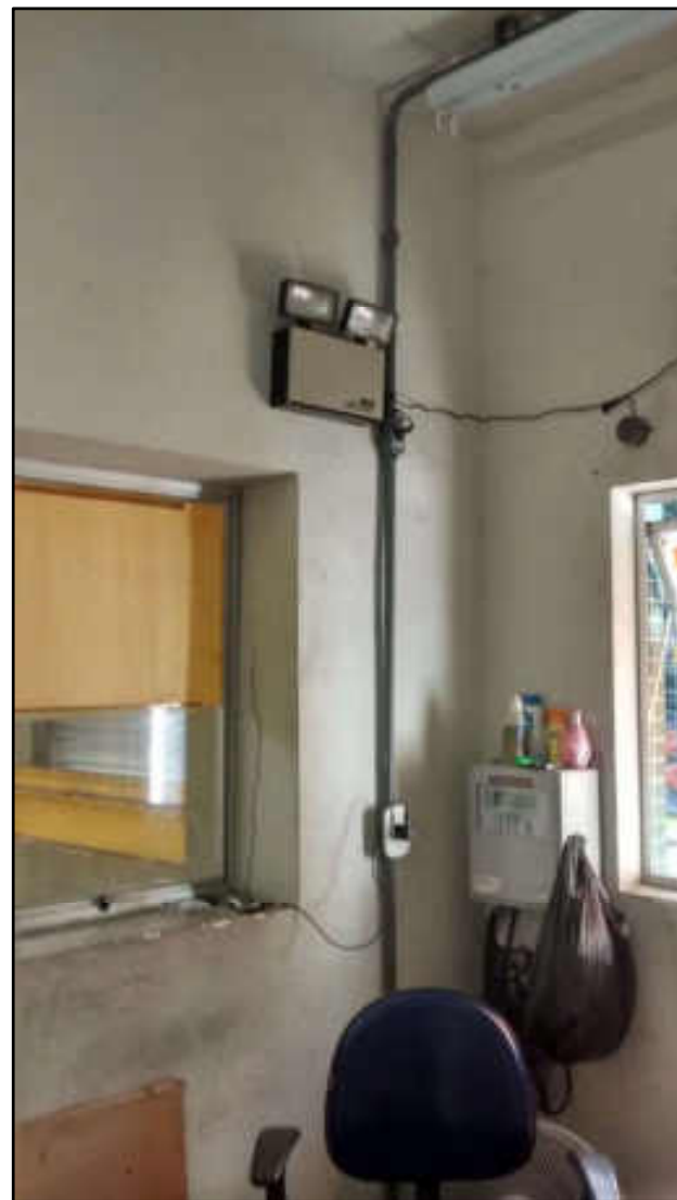
Sala do operador
