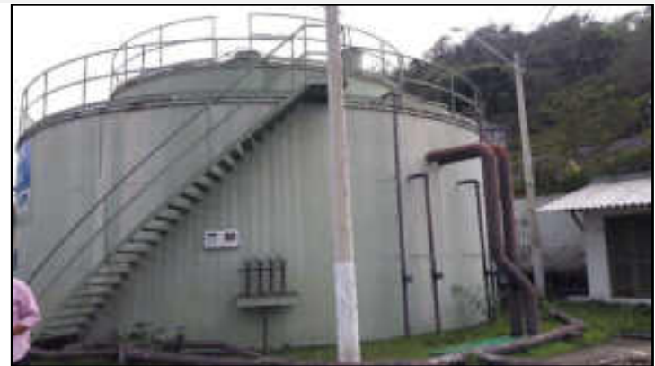
Tanque de decantação e tratamento
