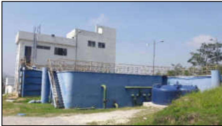
Vista geral da ETA
