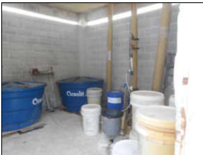
Vista interna da casa de química da UT de Pipeiras
