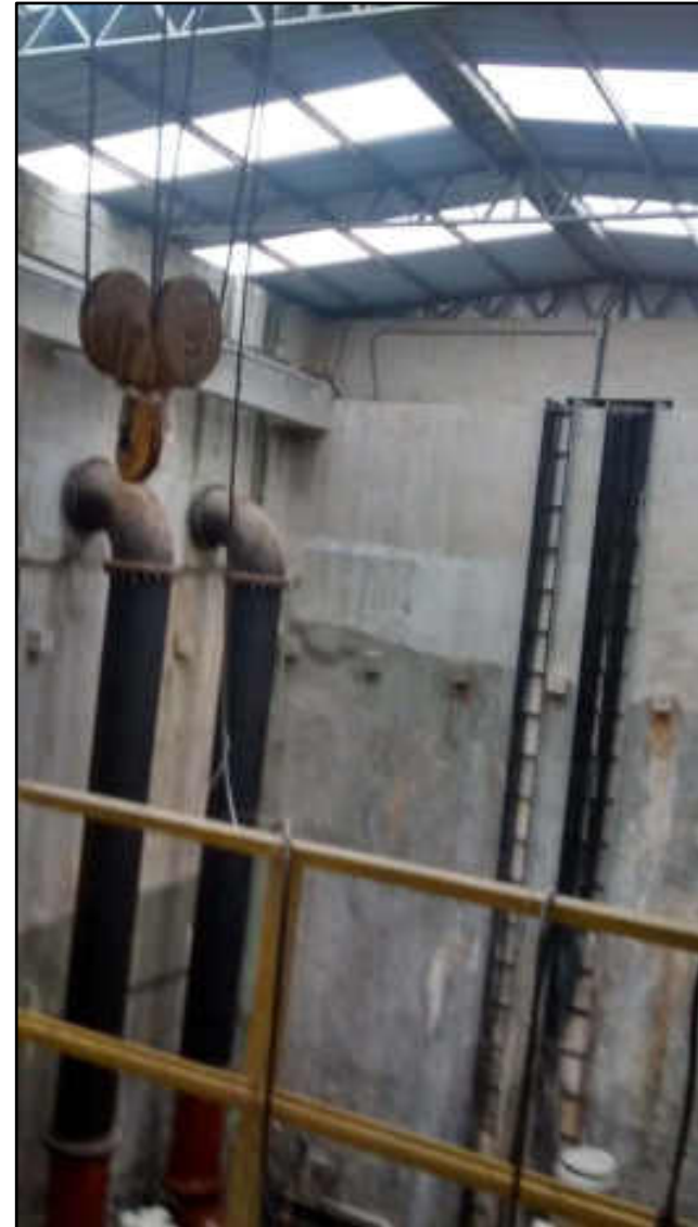
Área interna do salão de bombas
