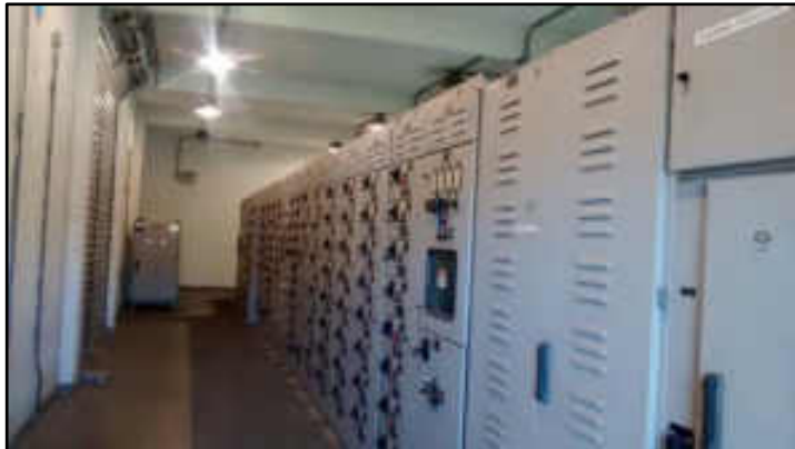
Área interna da subestação - sala de painéis
