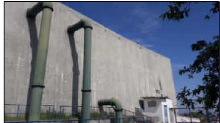
Reservatório - chegada d'água
