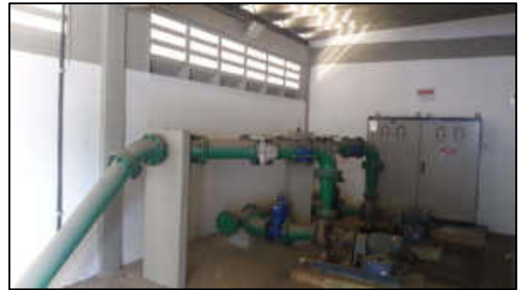
Estação elev de lavagem de filtro - recirculação
