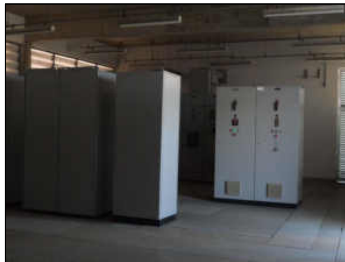
Sala de painéis
