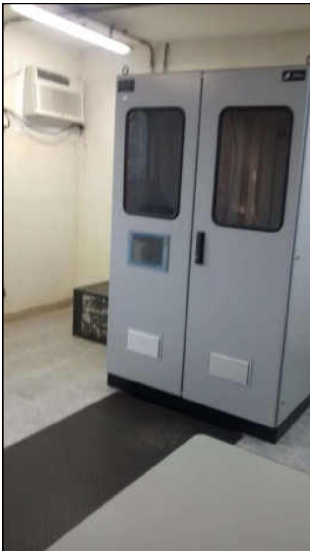
Prédio principal sala de painéis
