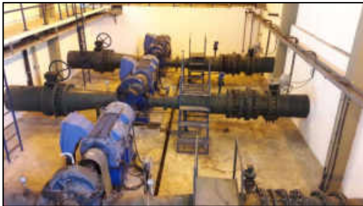
Salão de bombas
