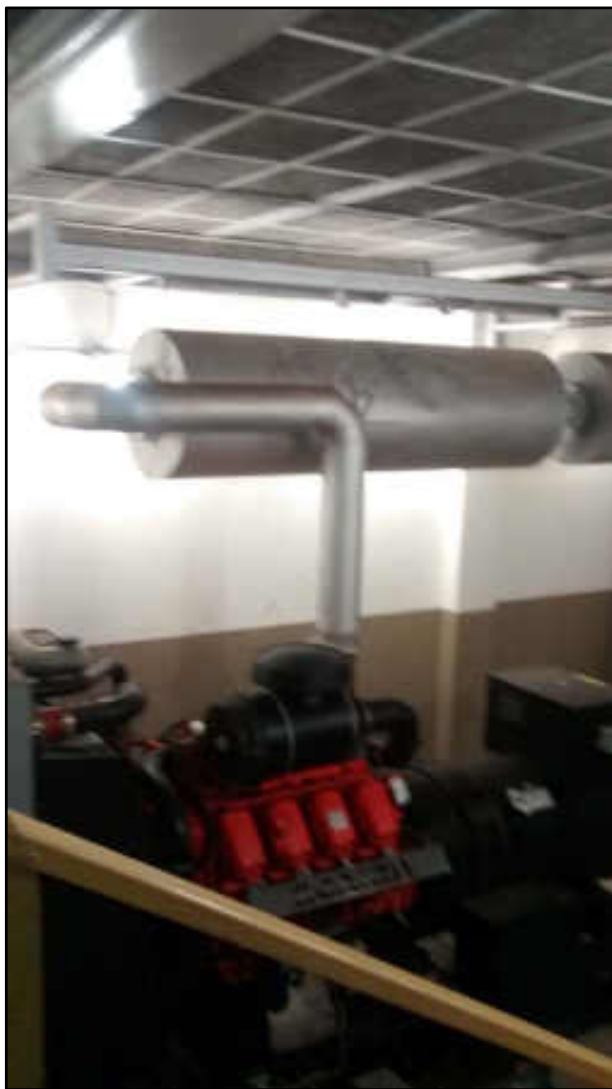
Prédio principal sala do gerador
