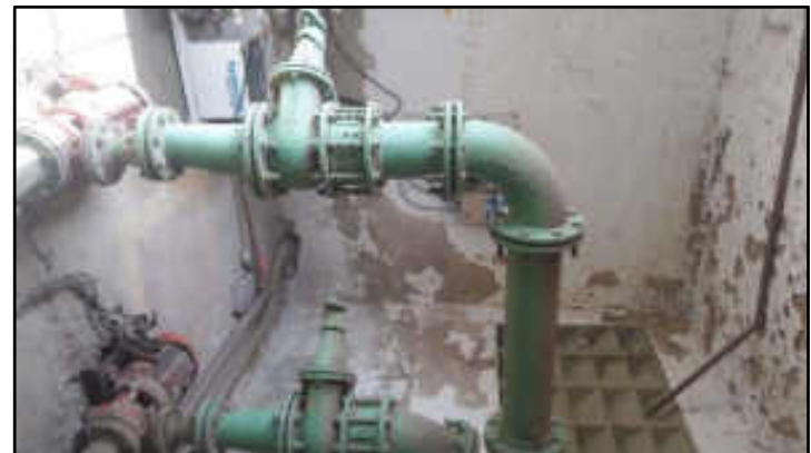
Salão de bombas - antigo
