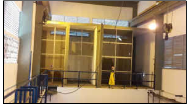
Sala de painéis
