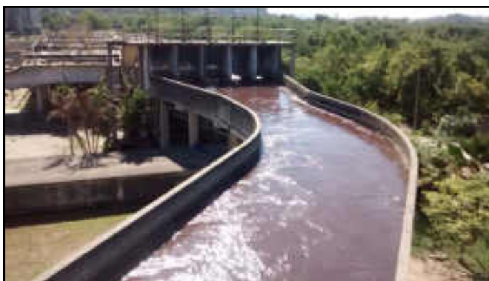
Canal efluente do gradeamento fino
