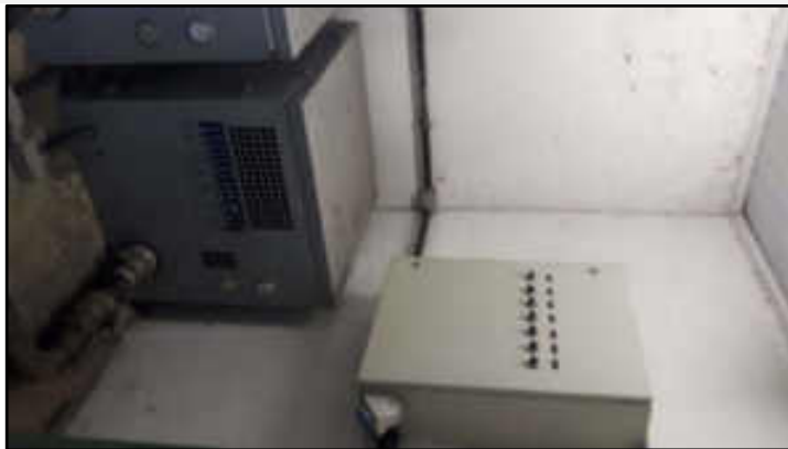
Sala de bombas
