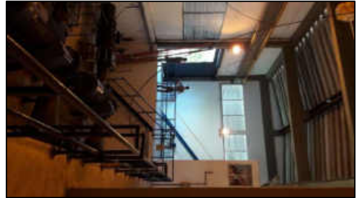
Salão de bombas
