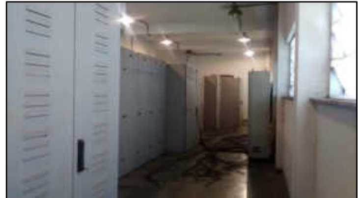
Área interna da subestação - sala de painéis
