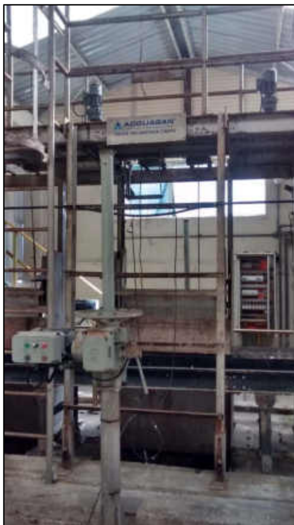
Área interna da sala de gradeamento grosseiro
