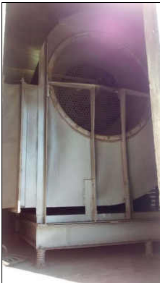
Sala dos exaustores
