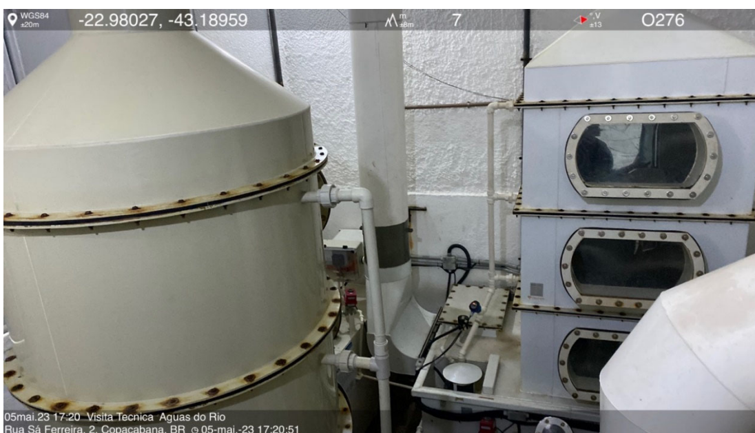
Foto 4: Estação Elevatória Parafuso na praia de Copacabana, vista interna, com o sistema de filtragem de gases.
