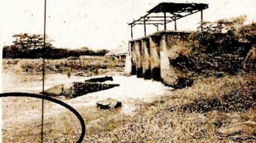
FOTO 8 - ESCOMBROS DA ESTRUTURA DA PARTE FRONTAL
