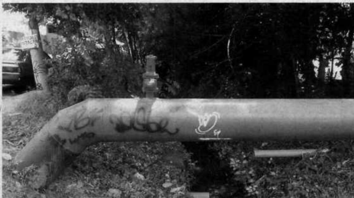
ESTRADA DOS BANDEIRANTES X RUA CLÁUDIO JACOBY - BAIRRO VARGEM PEQUENA DETALHE DA VENTOSA EM ADUTORA DE DIÂMETRO DE 600 MM - VISTORIA TÉCNICA MARÇO 2017
