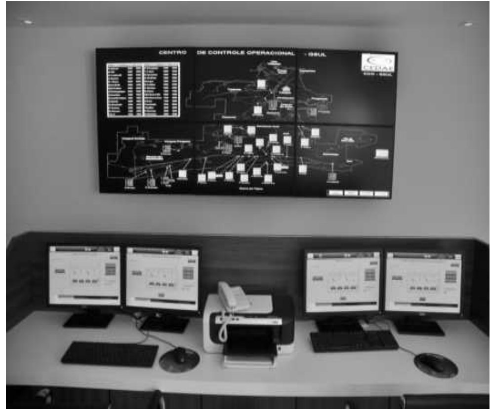
Centro de Controle Operacional
