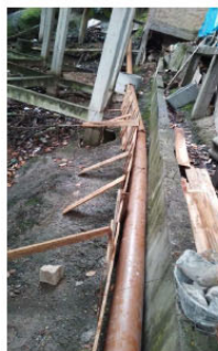
Instalação em local de difícil acesso
