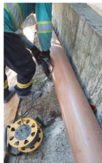
Instalação em local de difícil acesso
