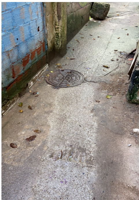
Foto 1 - PV com tampa metálica (cota mais alta)
