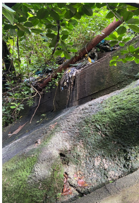
Foto 10 - Local onde ocorria despejo de esgoto a “céu aberto”
