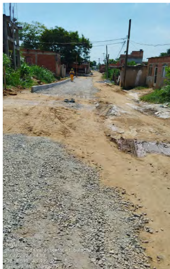
Foto 18 - Rua A (Rede não executada ainda)
