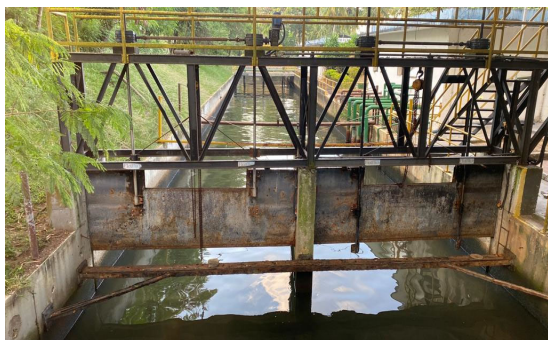
Foto 13 - UTR – Unidade de Tratamento de Rio
