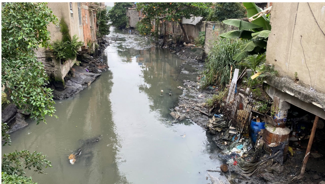
Foto 2: Complexo da Maré, canal de drenagem que recebe contribuição de esgoto e que desagua na Baía de Guanabara.
