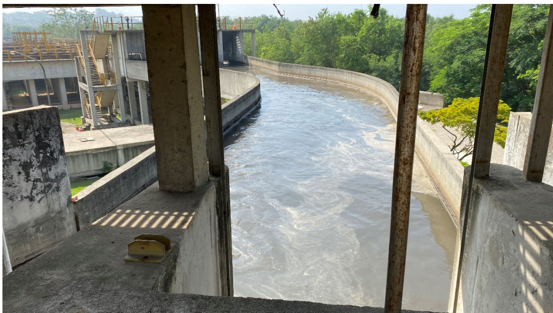
Foto 7: Estação de Tratamento de Esgotos (ETE) Alegria, vista de parte do sistema de tratamento.
