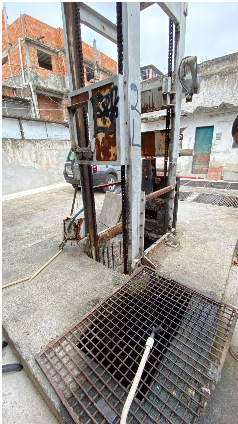
Foto 3: Complexo da Maré, estação elevatória.
