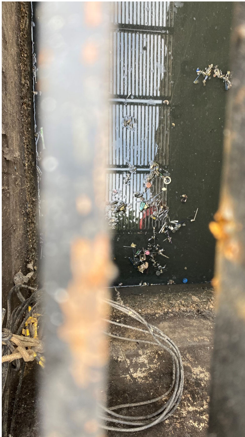
Foto 4: Complexo da Maré, detalhe reservatório estação elevatória.
